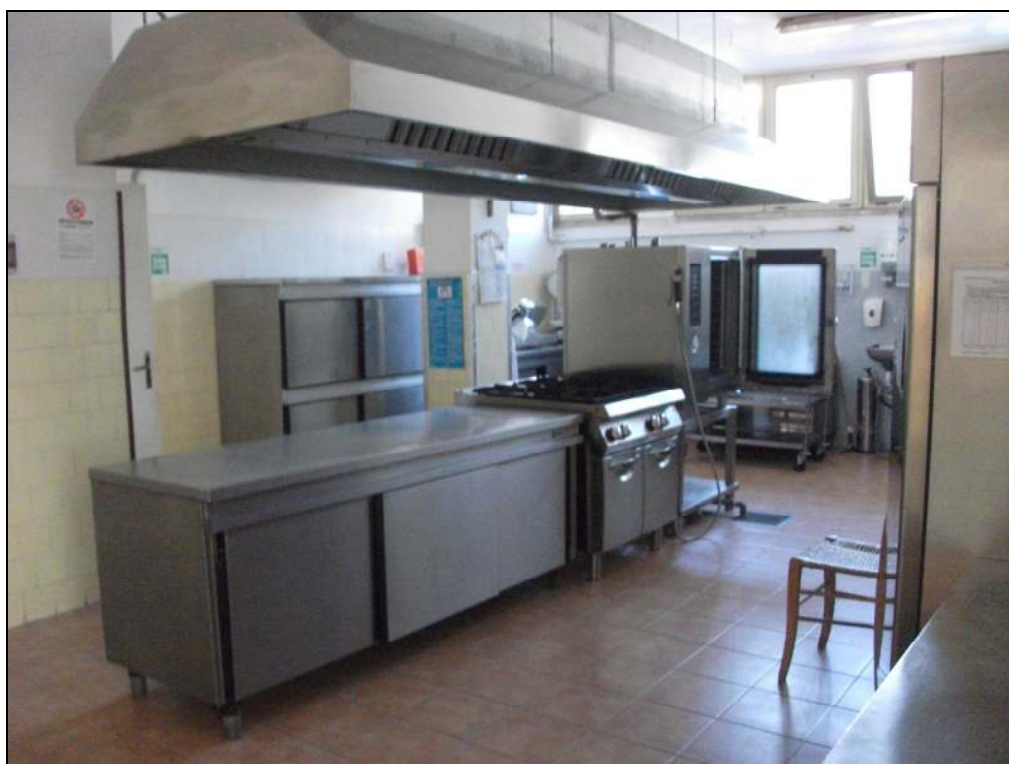
Foto 5 - interno mensa centro cottura in Via Luigi Mannetti
