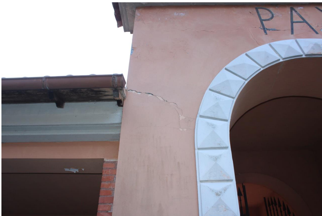
Figura 09 – Lesione in corrispondenza dell'attacco della porzione svettante
