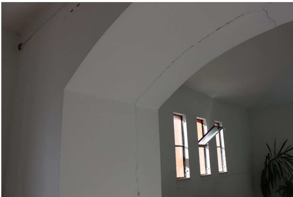
Figura 11 – Lesione all'interno della camera mortuaria generata da due elementi realizzati in aderenza ma non strutturalmente connessi
