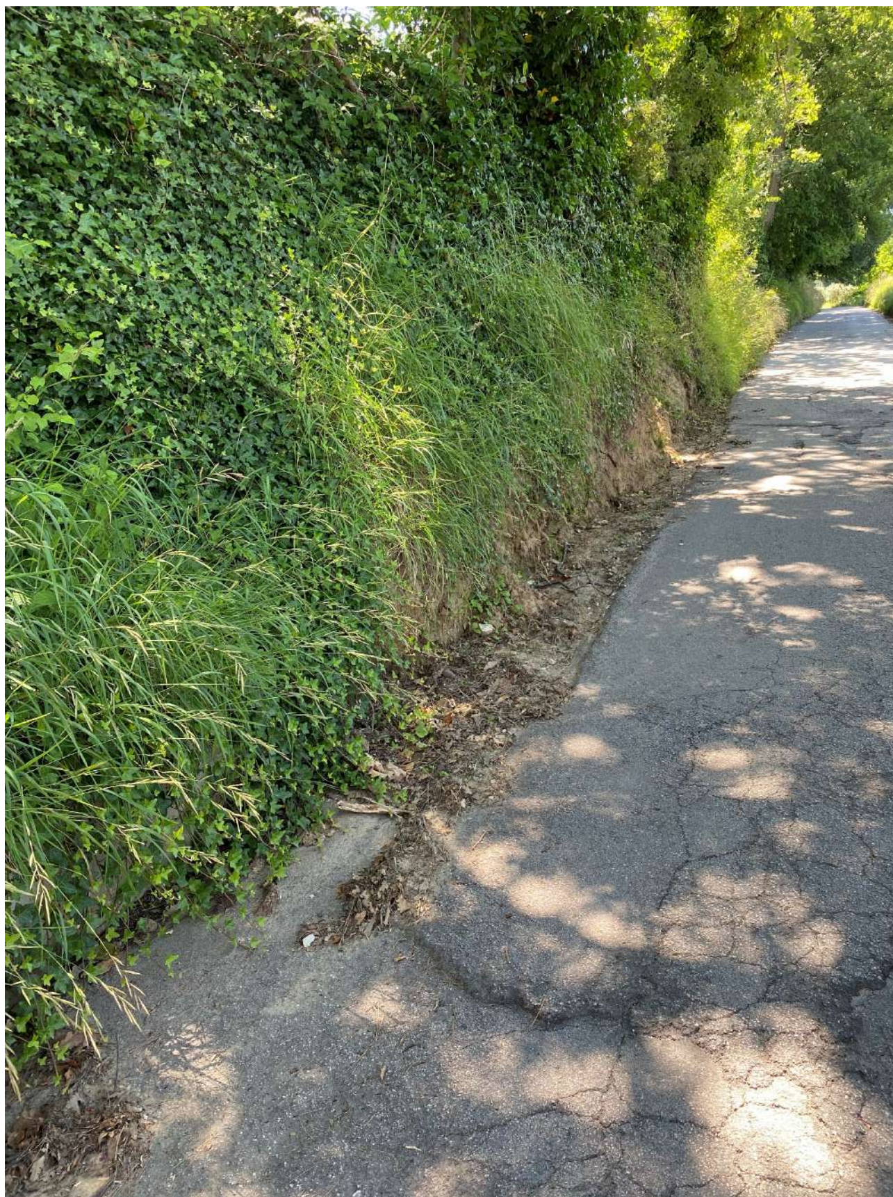
Foto 2 – Sez 0 lato sx
