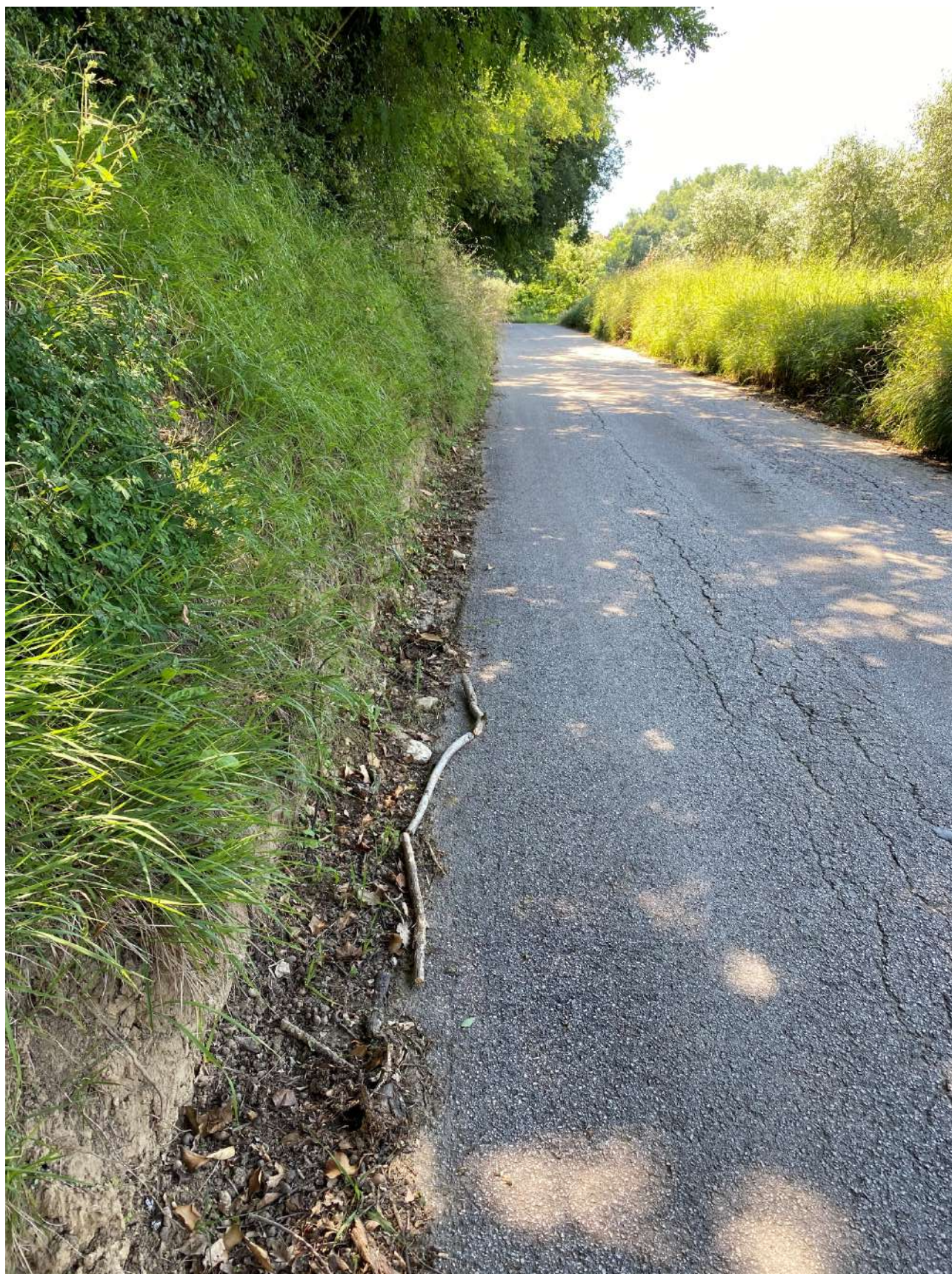
Foto 4 – Sez 1 lato sx
