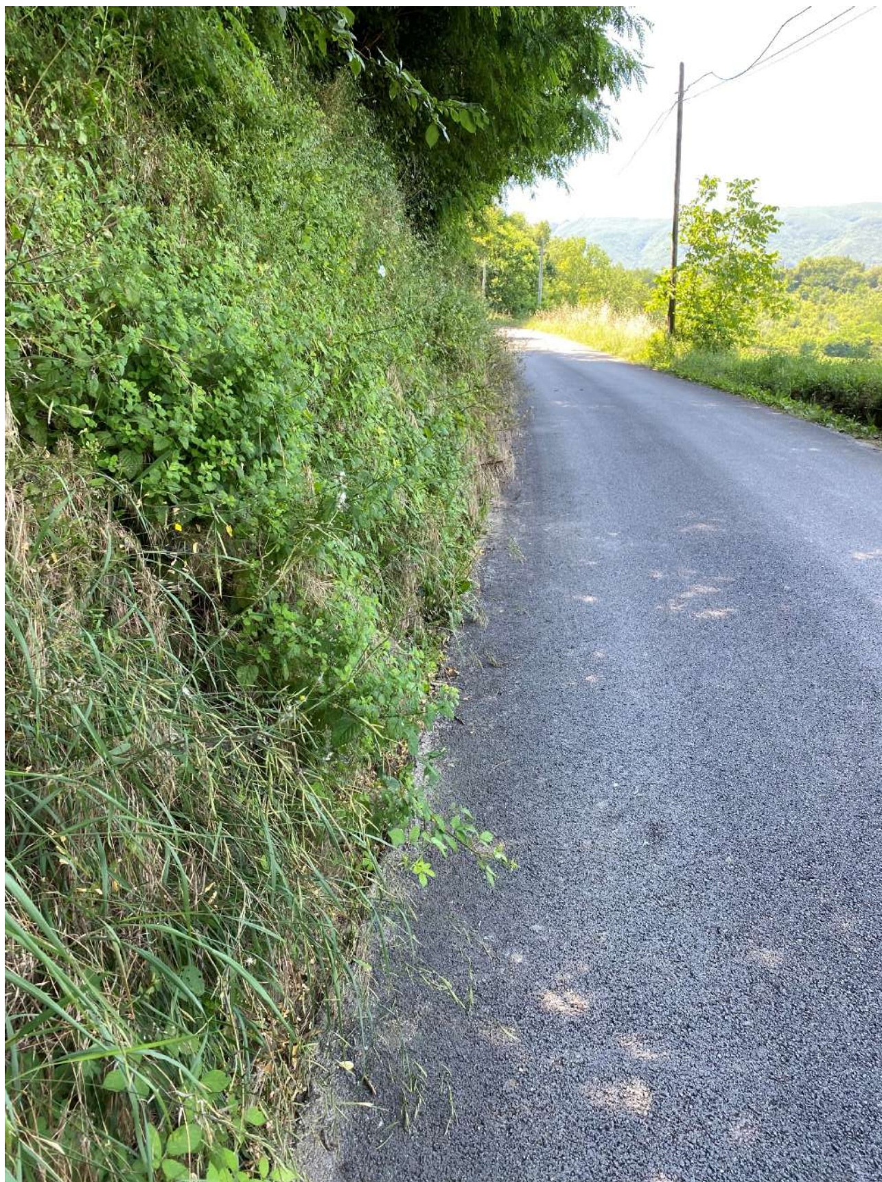
Foto 18 – Sez 8 lato sx
