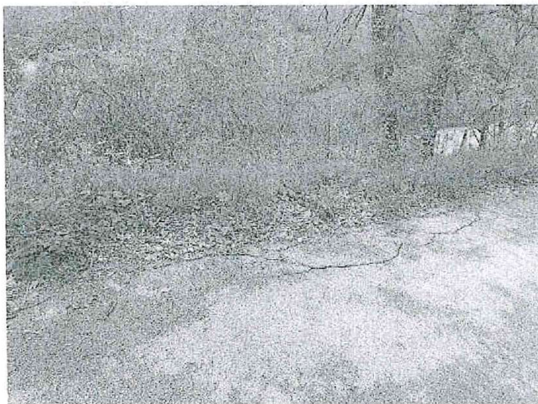
Foto 1: Cedimenti interni all'abitato
