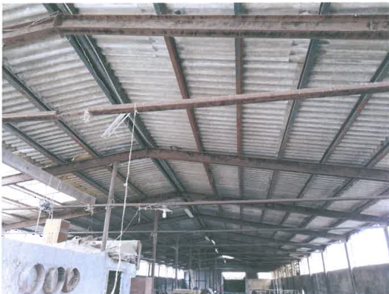
Foto 5 – Copertura in eternit stalla inagibile
