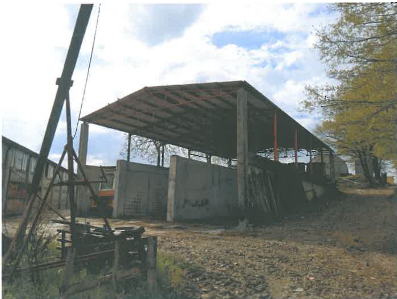
Foto 3 – Fienile inagibile adiacente strada comunale
