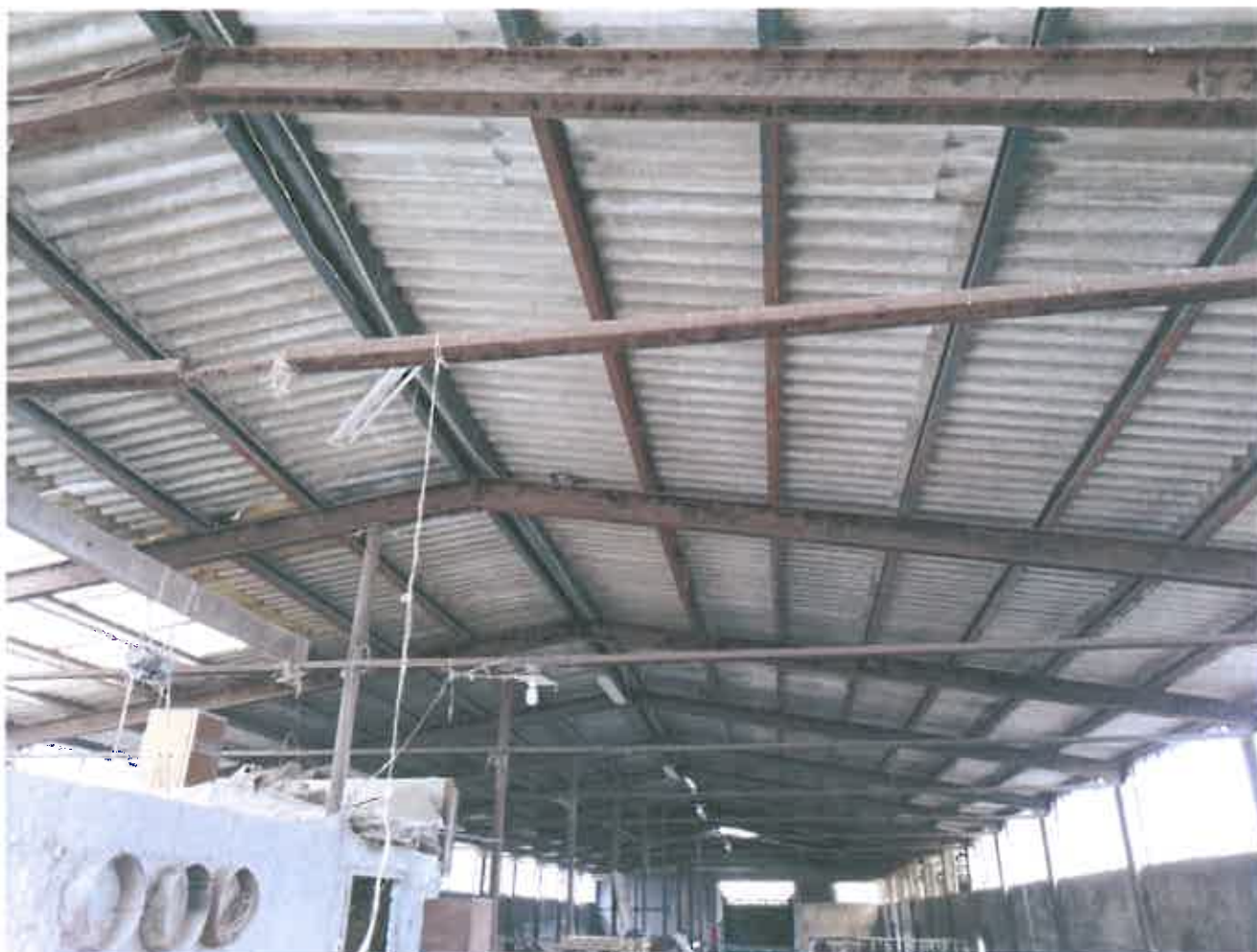
Foto 5 – Copertura in eternit stalla inagibile
