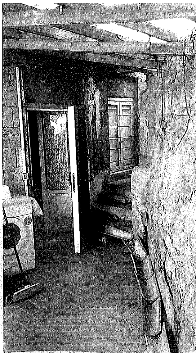
Prospetto di terrazzo sconfinante su proprietà Comunale
