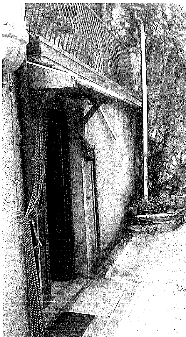
Porzione di fabbricato sconfinante su proprietà Comunale
