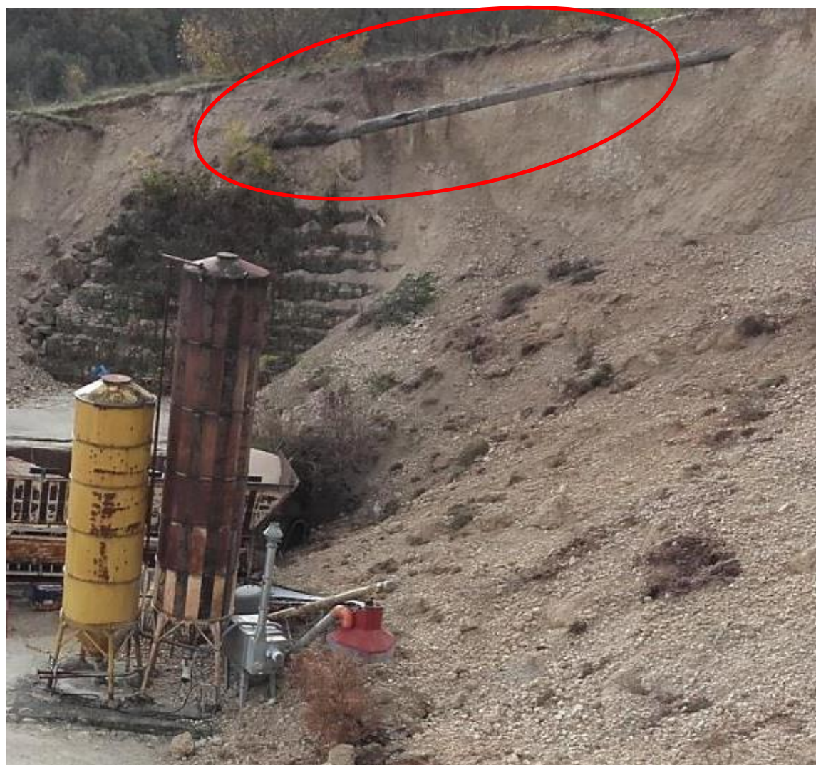
Acquedotto del Pescara, effetti del sisma 2016
