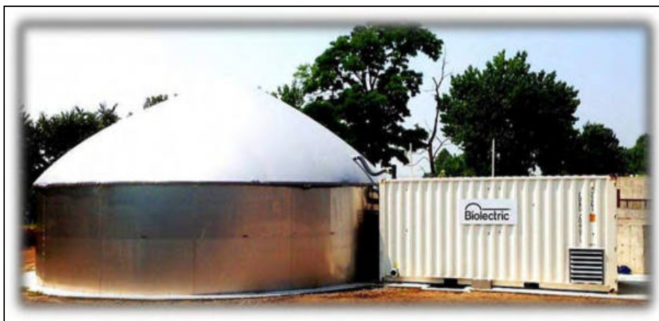
Fig.5 - Impianto di digestione anaerobica
