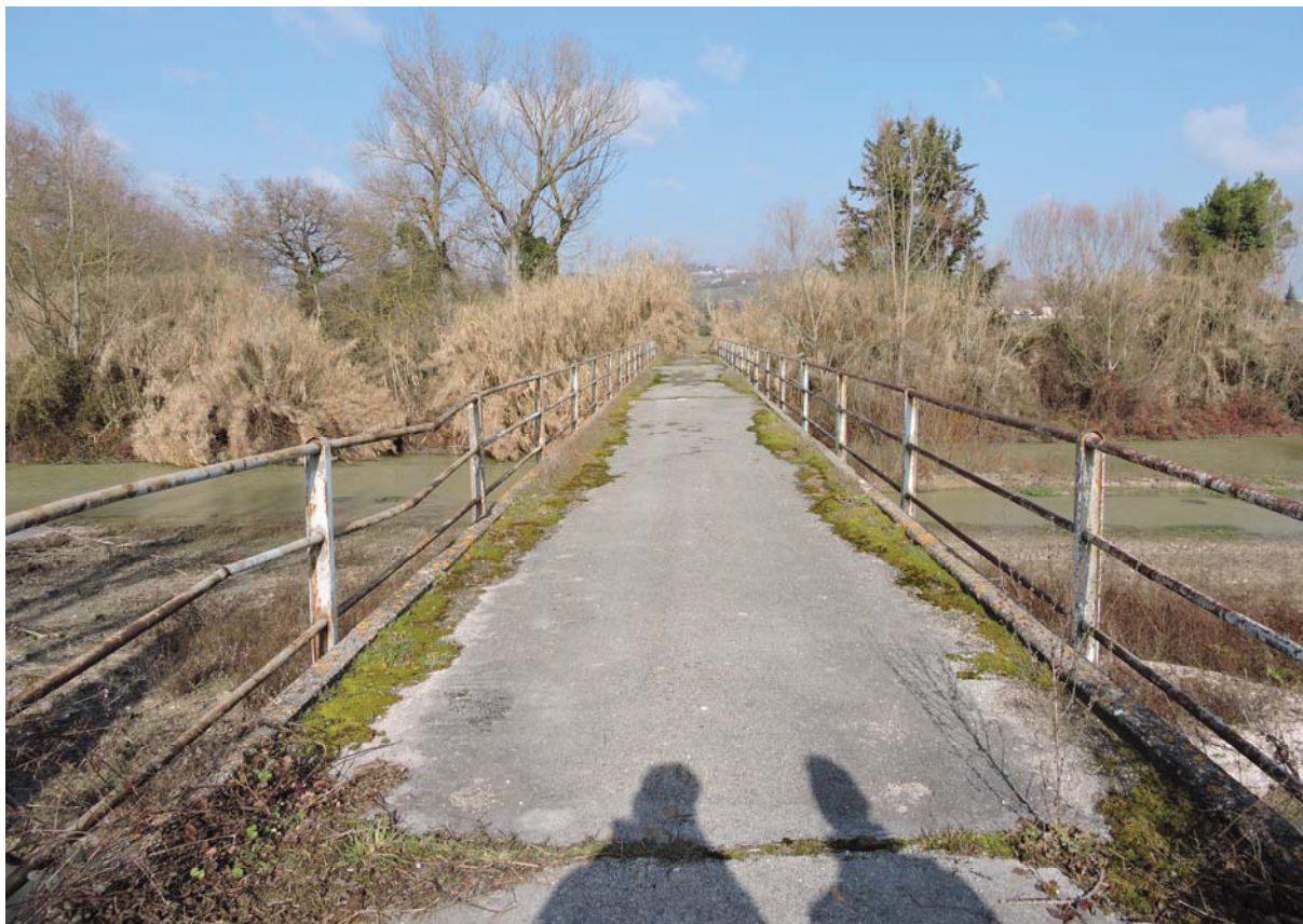
Stato di fatto: ponte con balaustre non a norma e fondo stradale degradato
