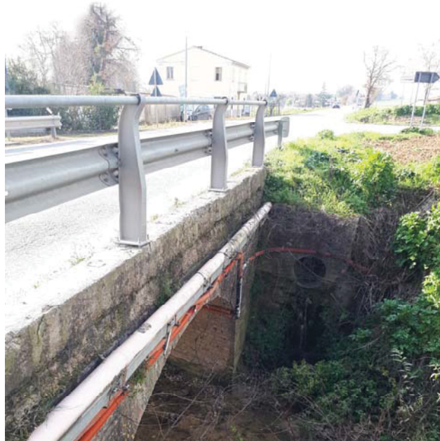
Stato di fatto: ponte non idoneo al passaggio pedonale
