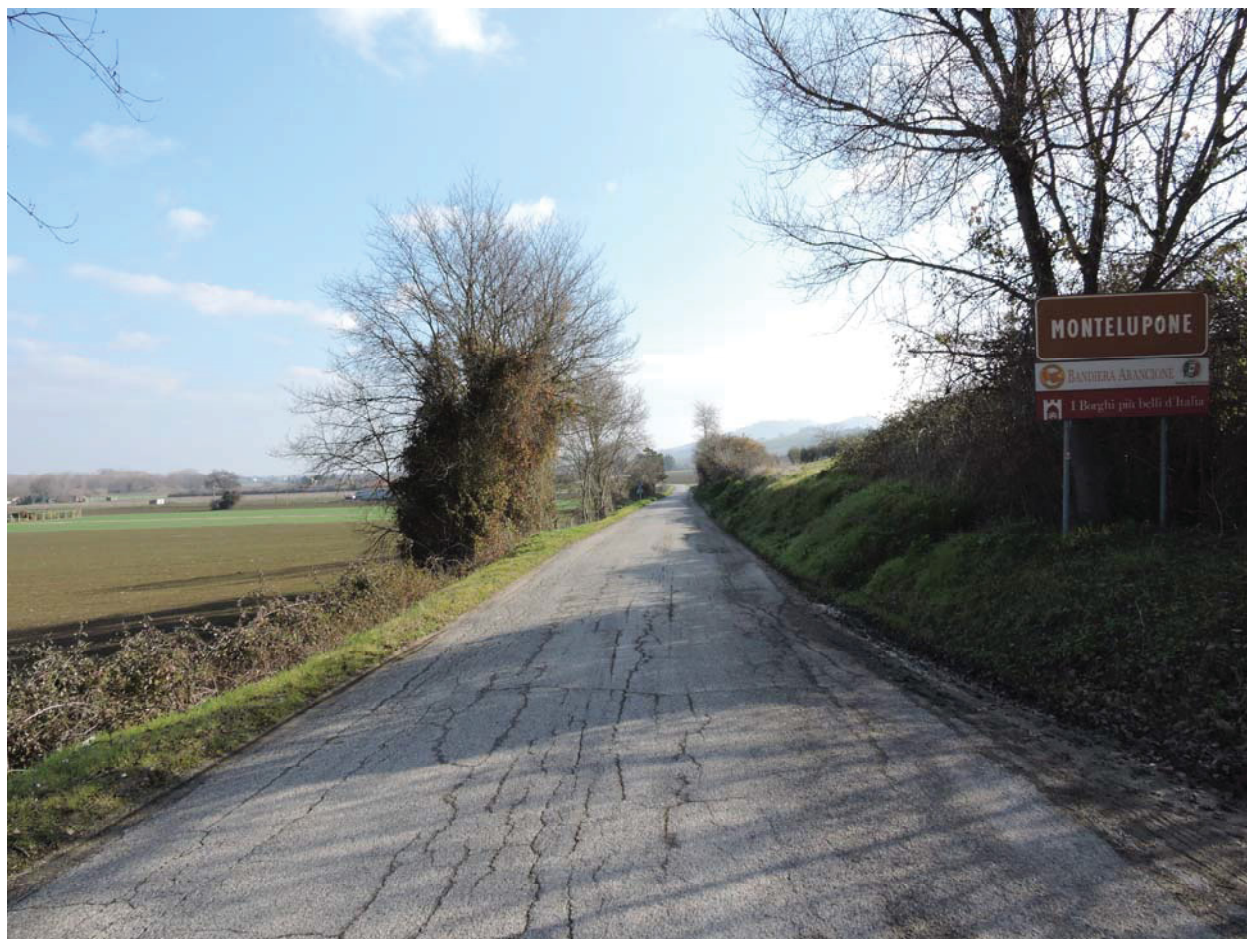
Stato di fatto: carreggiata con percorso laterale non idoneo al passaggio dei pellegrini
