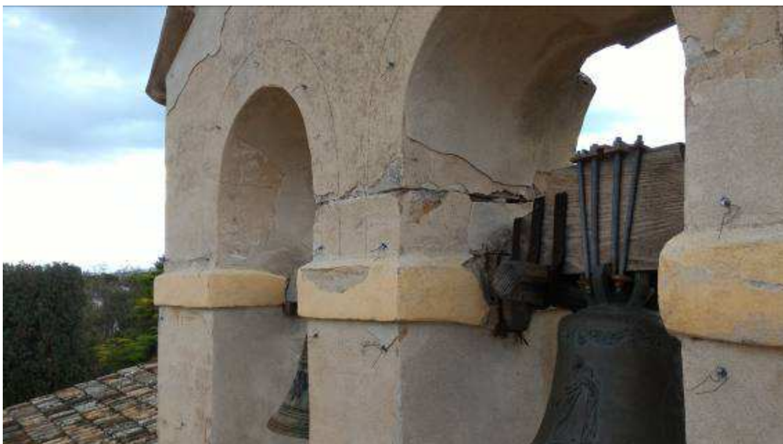
Foto 2 - lesioni sui pilastri in muratura delle celle campanarie
