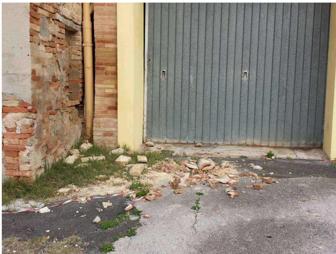
Materiale caduto su Via Sanzio
