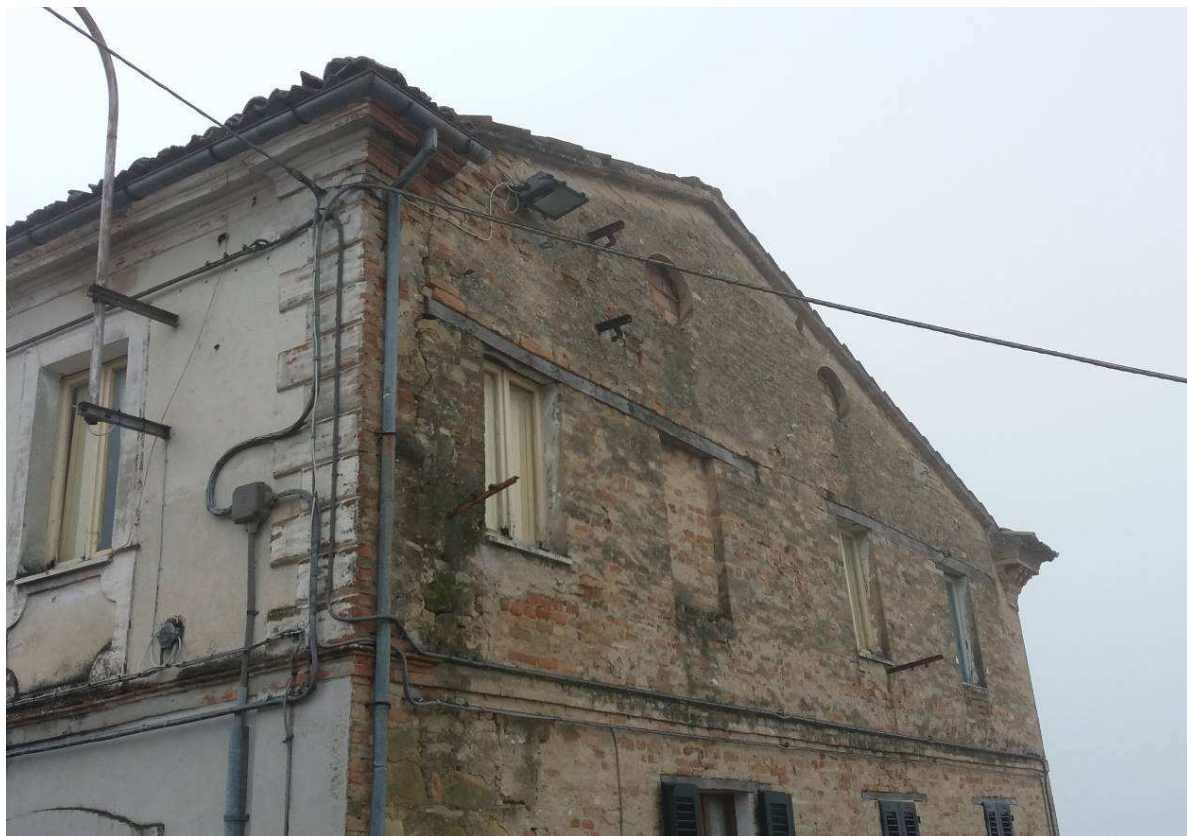
Prospetto Nord (Vista da Via Dante - Monte) – lesione incrocio pareti angolo
