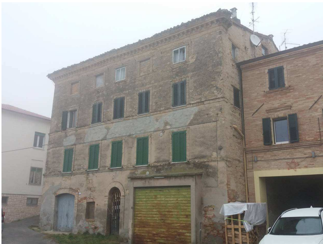
Prospetto Ovest (Via Sanzio) – cornicione pericolante e spigolo danneggiato
