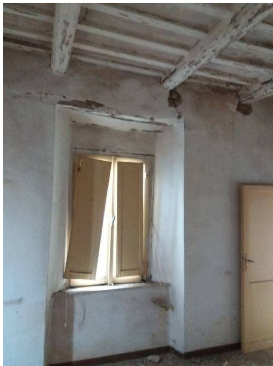
Particolare architravi e appoggi travi danneggiati
