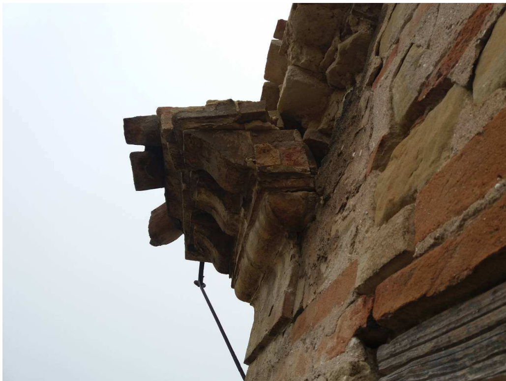
Particolare cornicione danneggiato angolo Sud - Ovest
