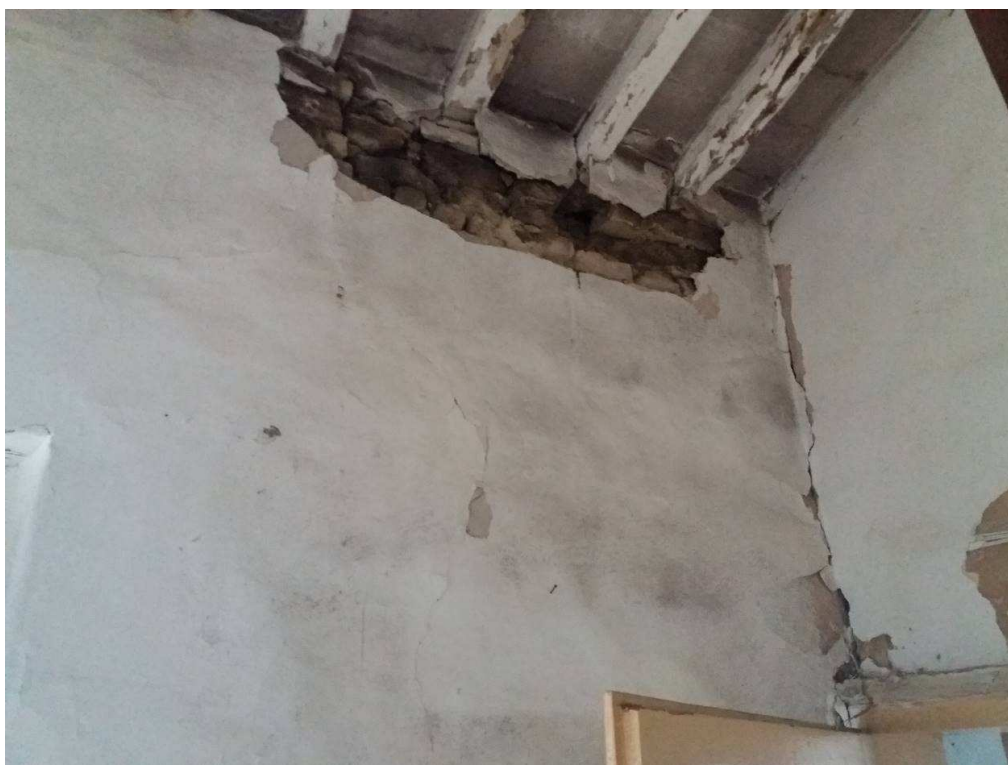
Particolare appoggio danneggiato travetti copertura
