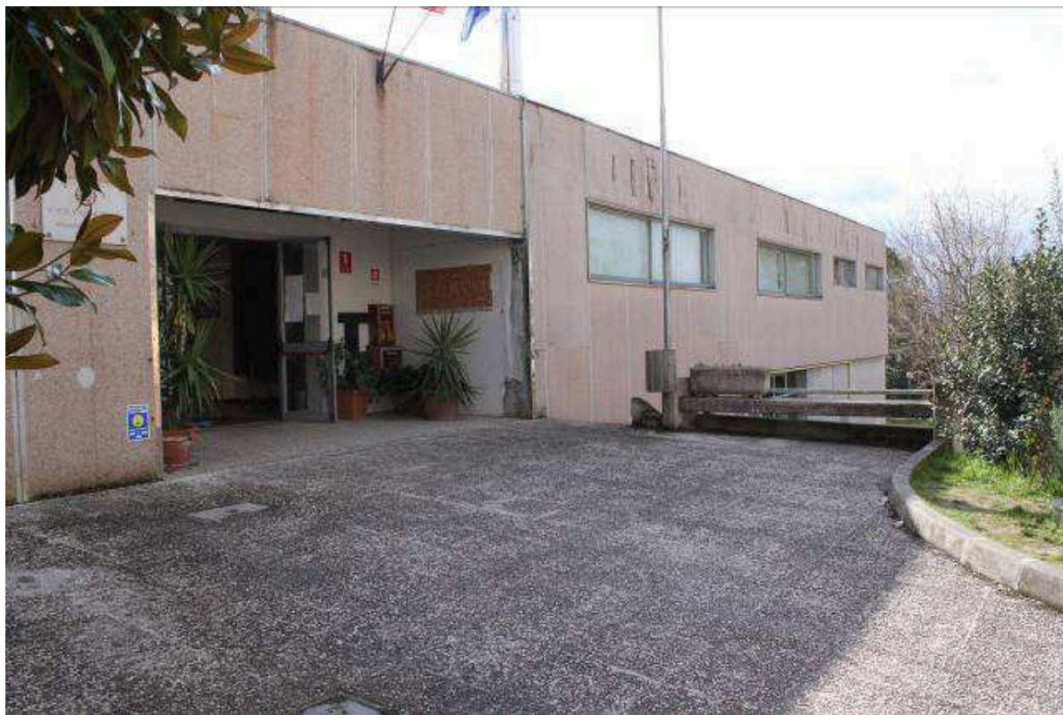
FIG.1: Ingresso istituto – fronte Nord. L'edificio si presenta fortemente ammalorato nei rivestimenti murari esterni e presenta dei forti distacchi superficiali.
