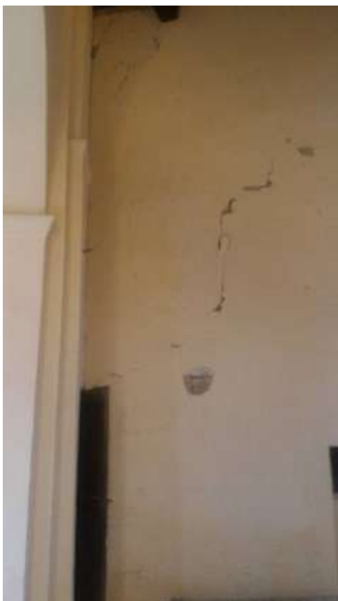
Foto 3 - divisorio aula carolingia danneggiato
