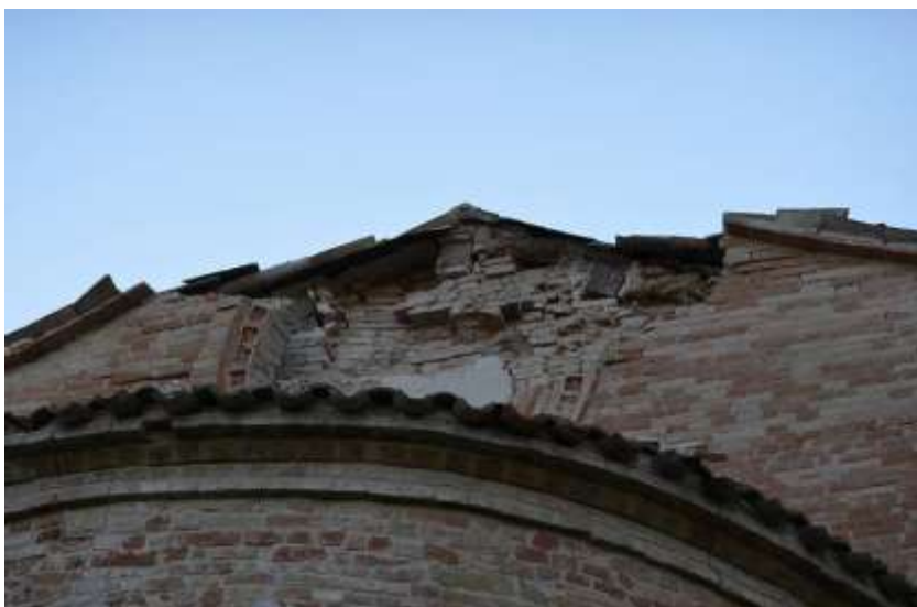
Foto 6 - crollo parete sopra abside
