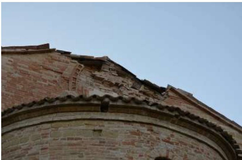
Foto 5 - crollo parete sopra abside
