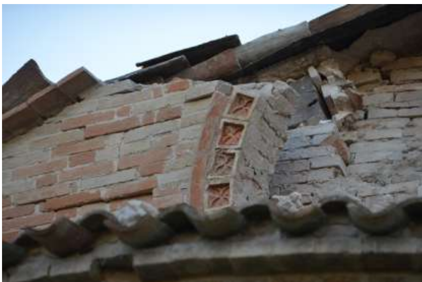
Foto 7 - crollo parete sopra abside - particolare interessamento rosone
