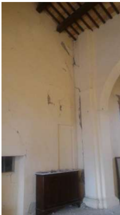
Foto 4 - divisorio aula carolingia danneggiato
