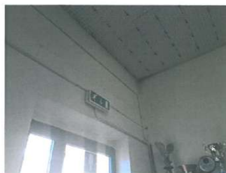
Foto 04: parete esterna (lato interno) con lesioni
