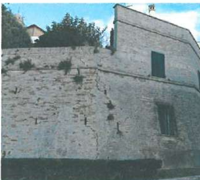
Foto n° 16 – lesioni verticali delle mura
