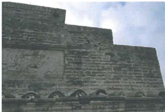
Foto n° 17 – Particolare sconnessione sommità della porta
