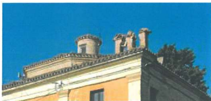
Foto n° 8 – situazione della cella dopo il sisma
