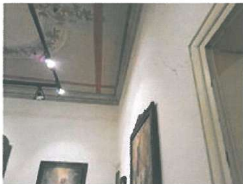
Foto n° 10 – lesione a 45° in parete e solaio affrescato
