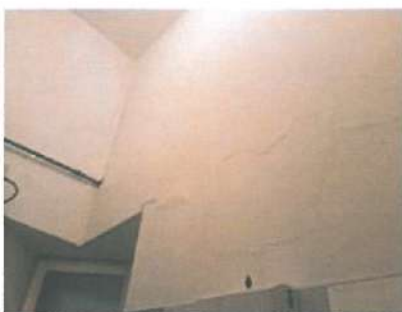
Foto n° 13 – lesione in corrispondenza di bucatore
