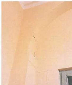
Foto n° 11 – lesioni su partizione
