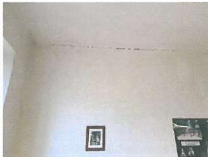
Foto n° 14 – distacco solaio parete
