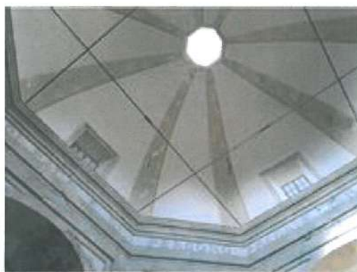
Foto n° 9 – lesioni frastagliate lungo le unghie della volta
