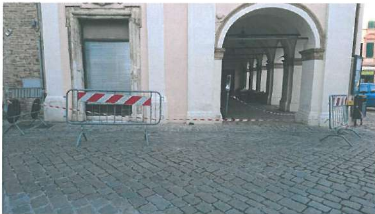
Foto 05-06: lesioni di distacco tra i due corpi di fabbrica e varie filature
