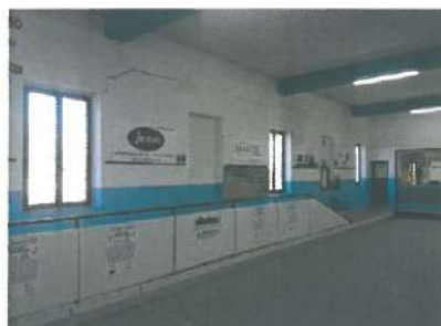
Foto 04: parete esterna (lato interno) con lesioni
