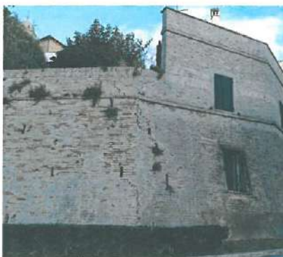
Foto n° 16 – lesioni verticali delle mura
