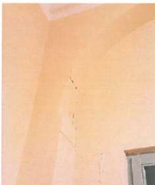
Foto n° 11 - lesioni su partizione
