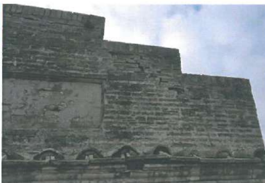
Foto n° 17 – Particolare sconnessione sommità della porta
