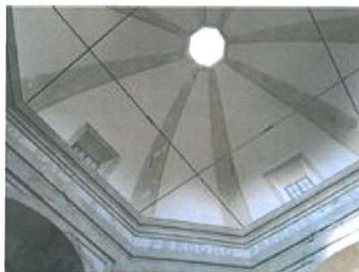
Foto n° 9 – lesioni frastagliate lungo le unghie della volta
