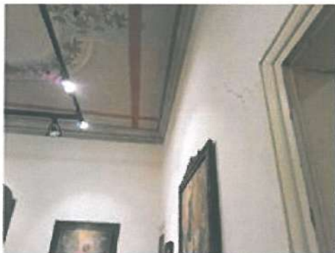
Foto n° 10 – lesione a 45° in parete e solaio affrescato
