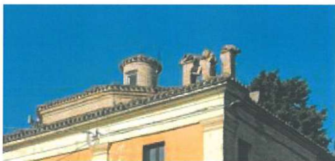
Foto n° 8 – situazione della cella dopo il sisma
