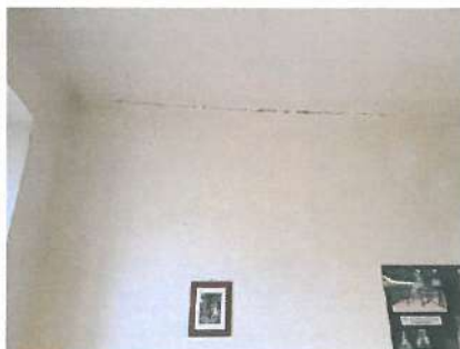
Foto n° 14 – distacco solaio parete
