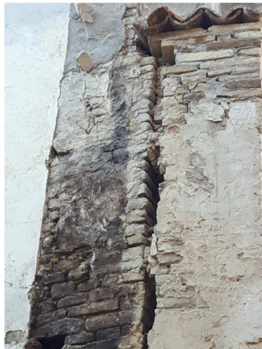
Foto 2 - particolare distacco pareti
