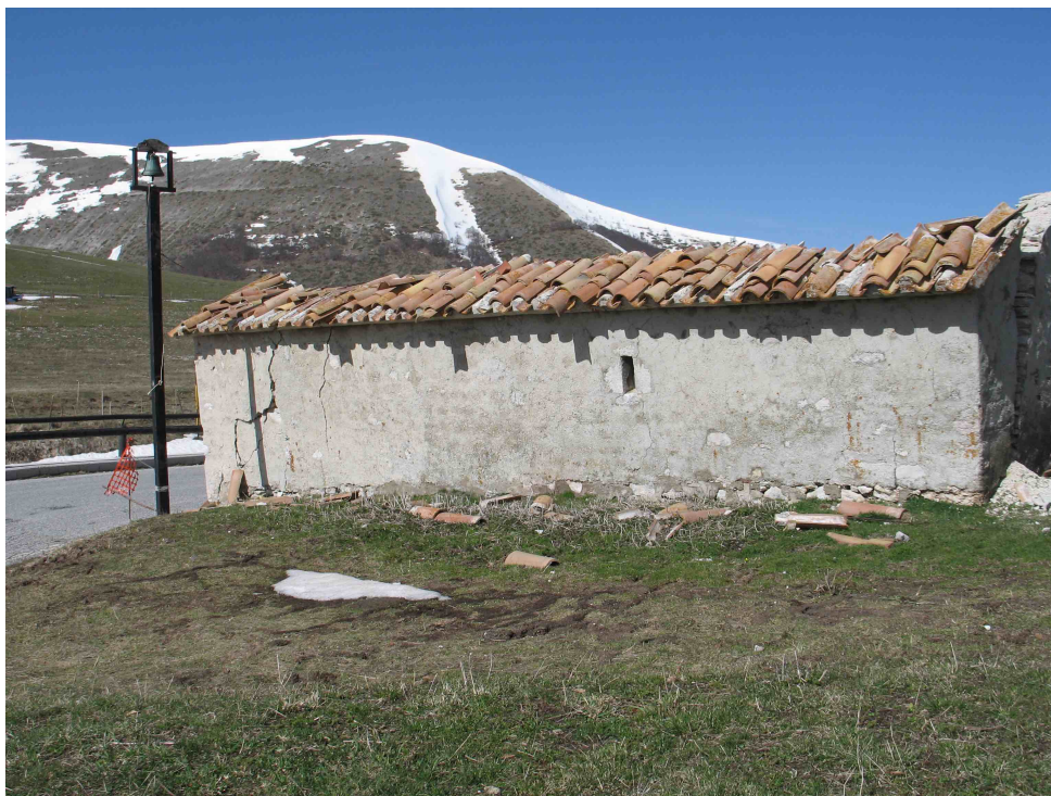
Foto 4: scorcio prospetto sud (dopo il sisma 2016)
