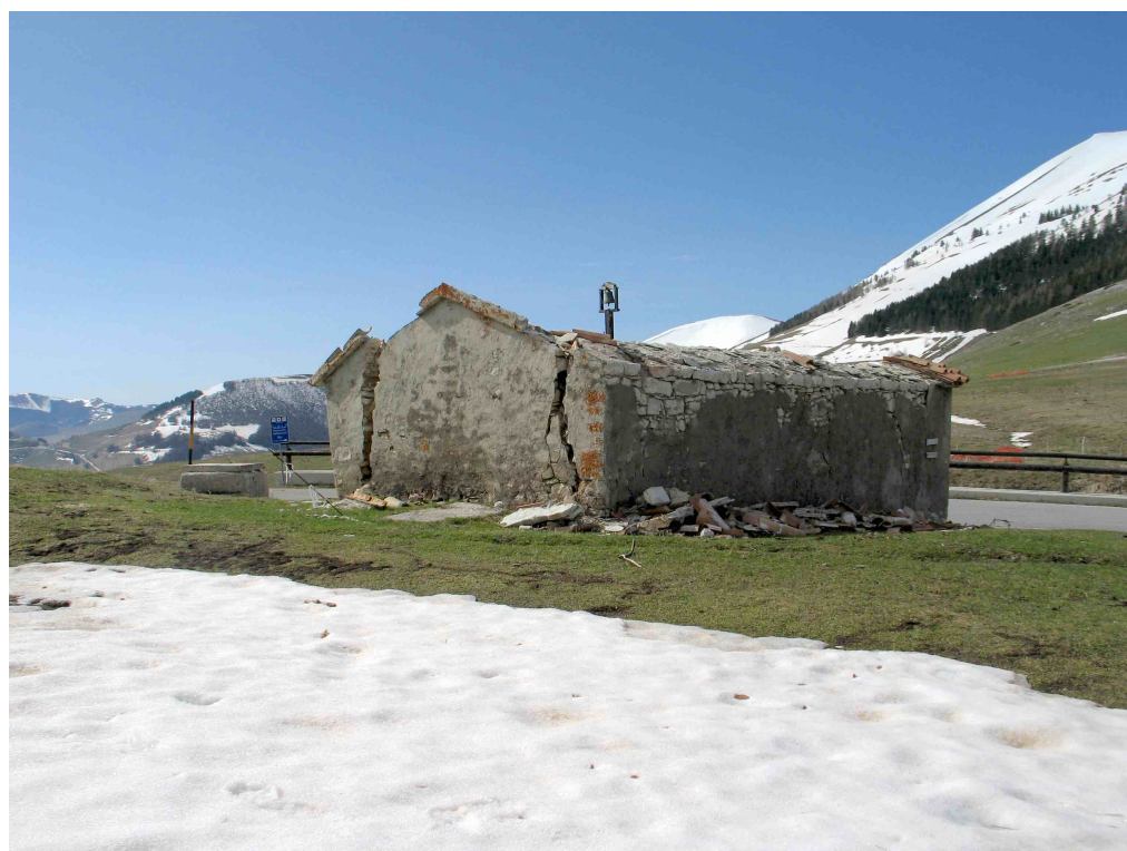
Foto 3: scorcio prospetti nord-est (dopo il sisma 2016)
