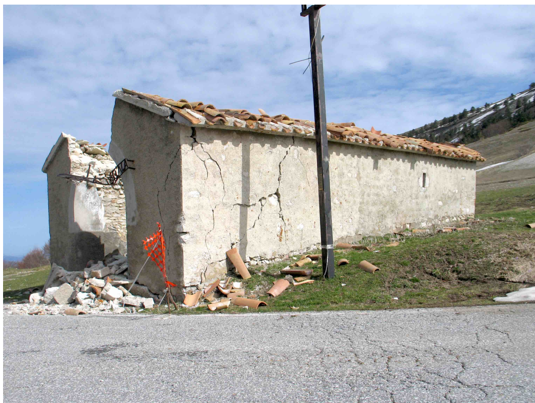
Foto 2: scorcio prospetti sud-ovest (dopo il sisma 2016)
