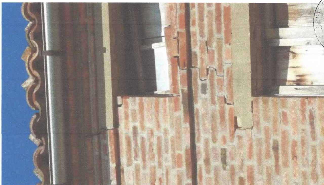
FOTO N. 1 – LESIONE PASSANTE SU MURI PORTANTI
