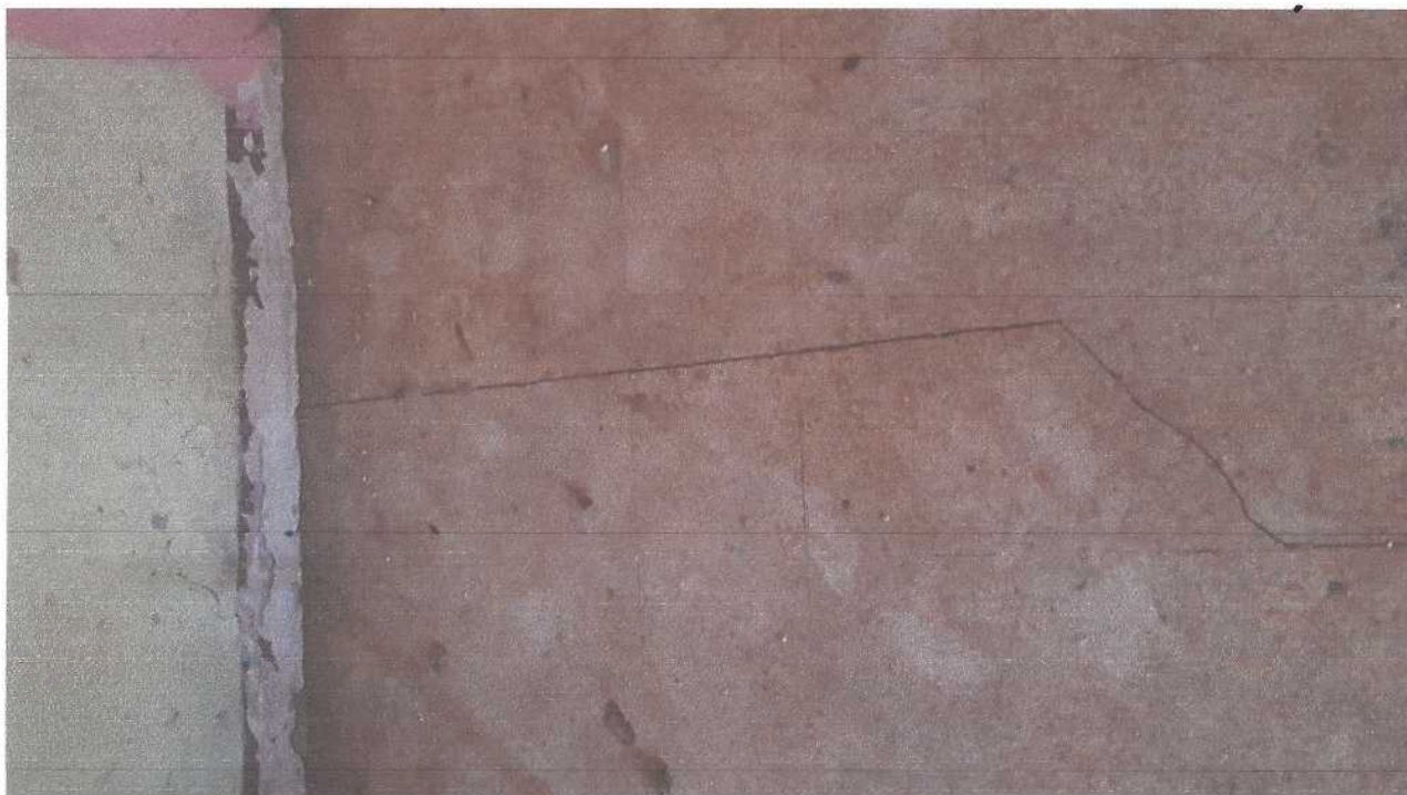
FOTO N. 13 – ROTTURA DELLA PAVIMENTAZIONE
