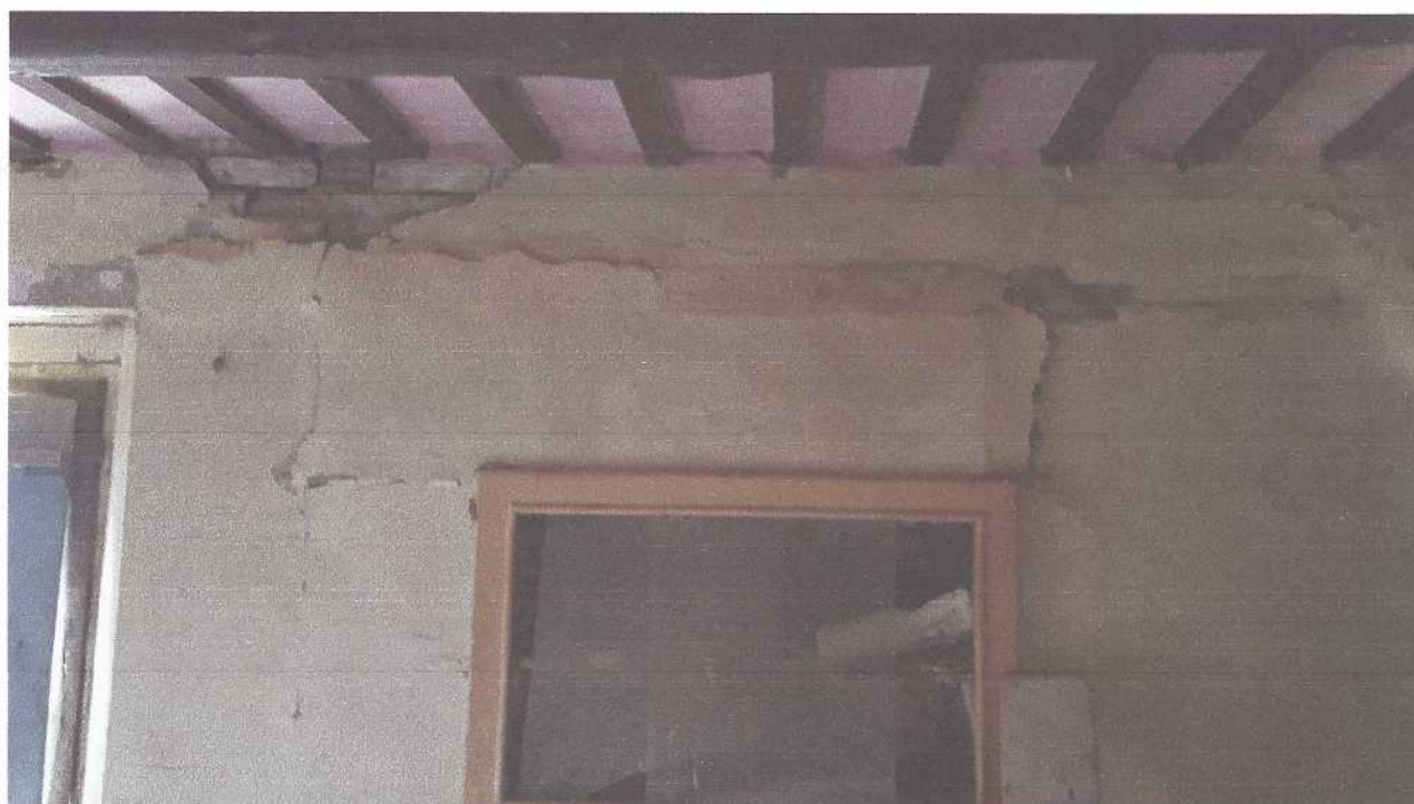
FOTO N. 8 - LESIONE SULLE MURATURE
