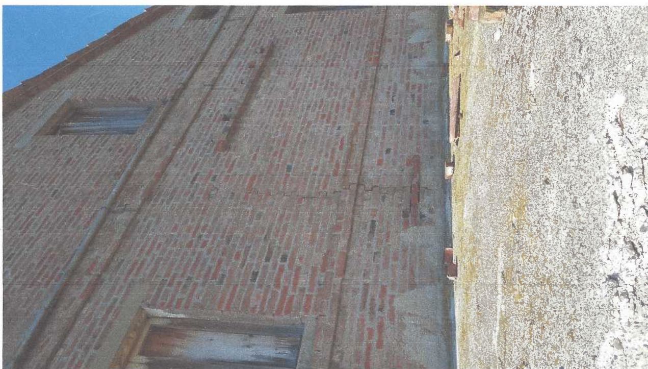
FOTO N. 14 – LESIONE SULLA MURATURA PORTANTE
