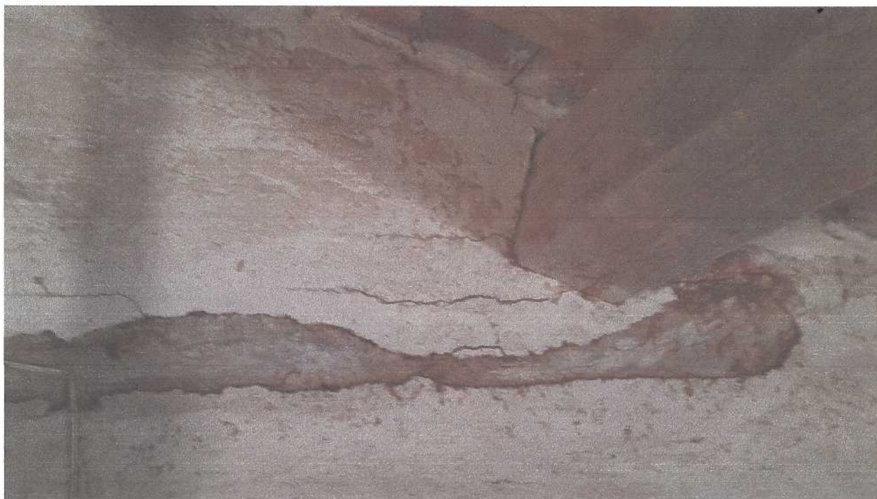
FOTO N. 11 – MOVIMENTO DELLE TRAVI DEL SOLAIO DI COPERTURA
