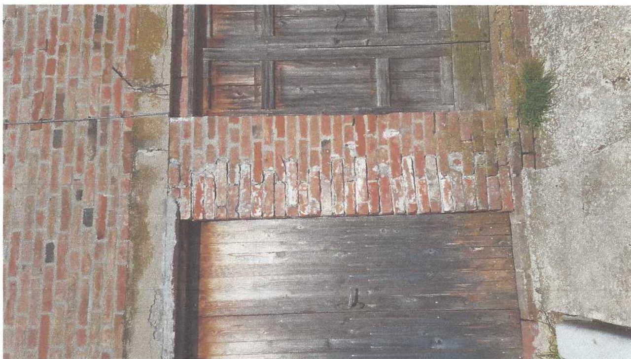
FOTO N. 2 – LESIONE SULLE APERTURE E SUGLI ARCHITRAVI
