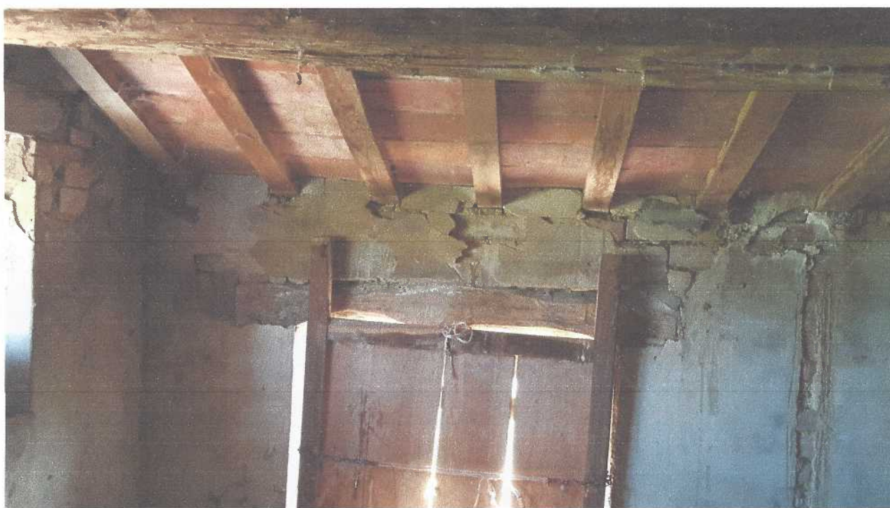
FOTO N. 10 – MOVIMENTO DELLE TRAVI DEL SOLAIO
