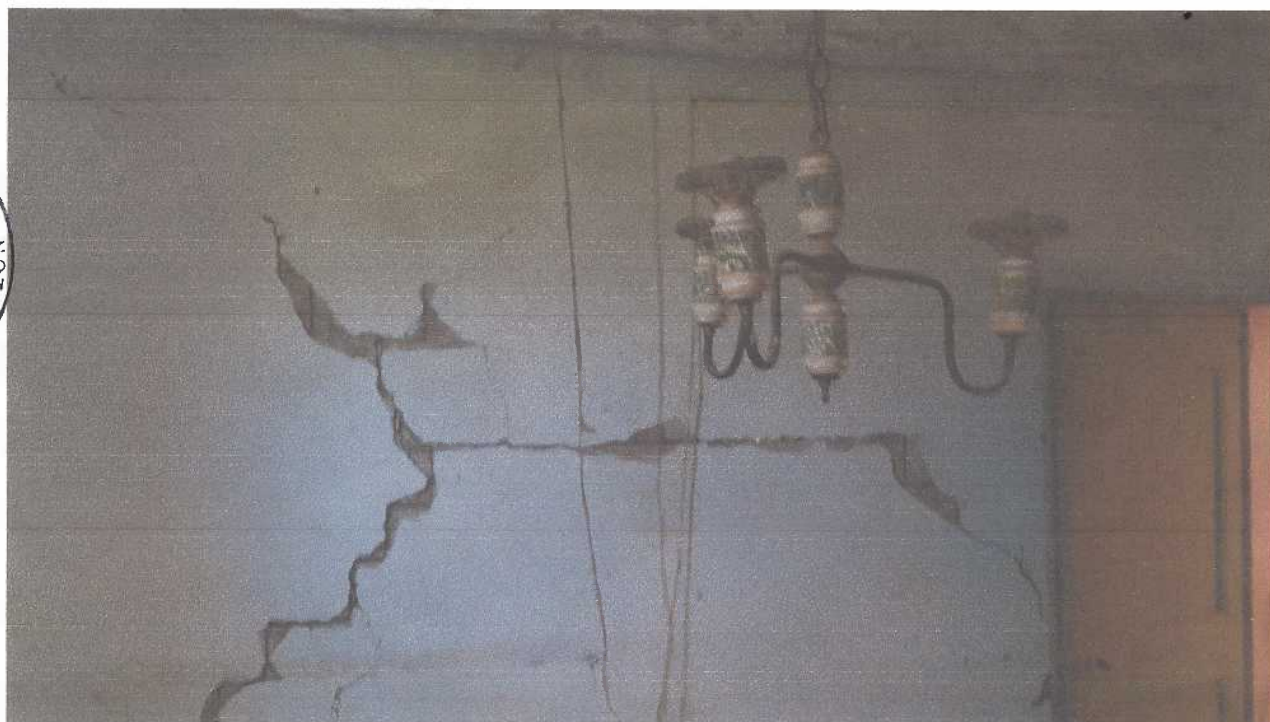
FOTO N. 7- ROTTURA DELLE MURATURE
