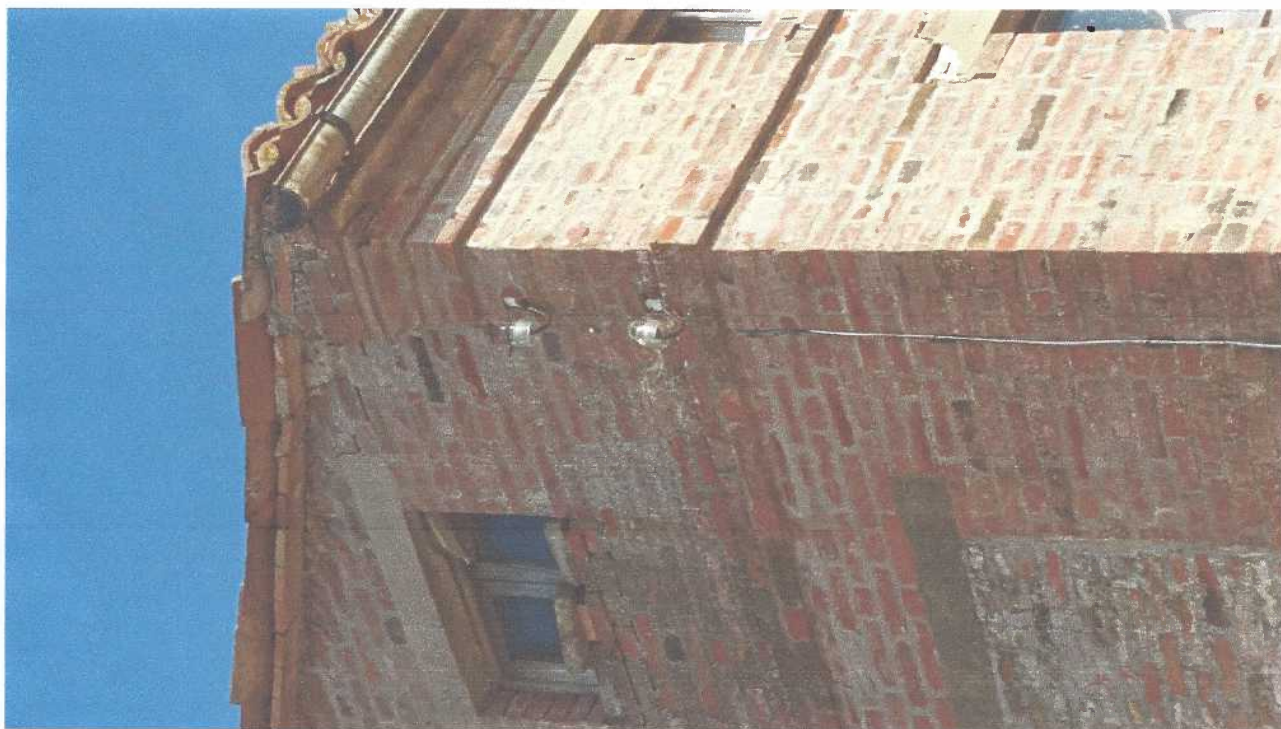
FOTO N. 3 – LESIONE SULL'ANGOLO E DISSESTO DEL TETTO
