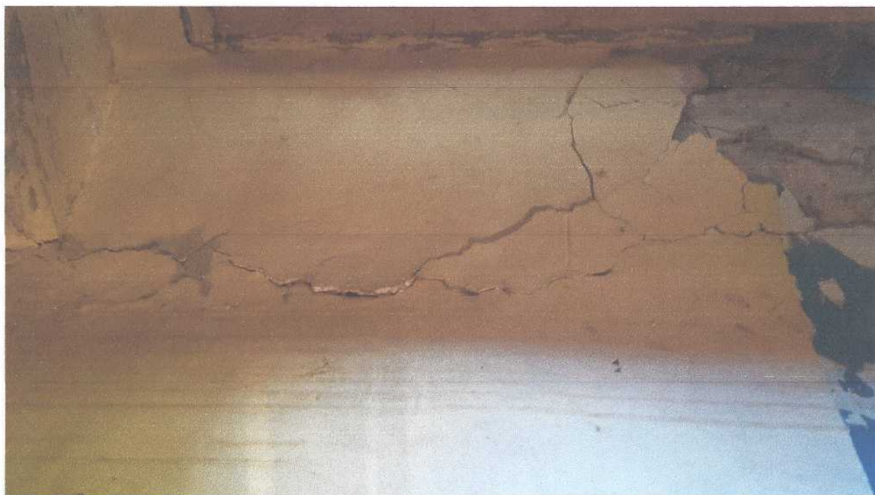
FOTO N. 6 – LESIONE SULLE MURATURE PORTANTI
