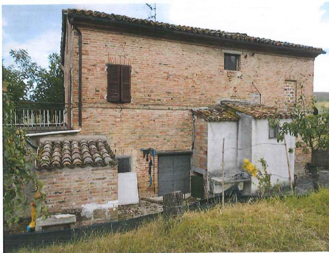
Particolare delle due superfetazioni, realizzate in mattoni intonacato di scarso pregio
