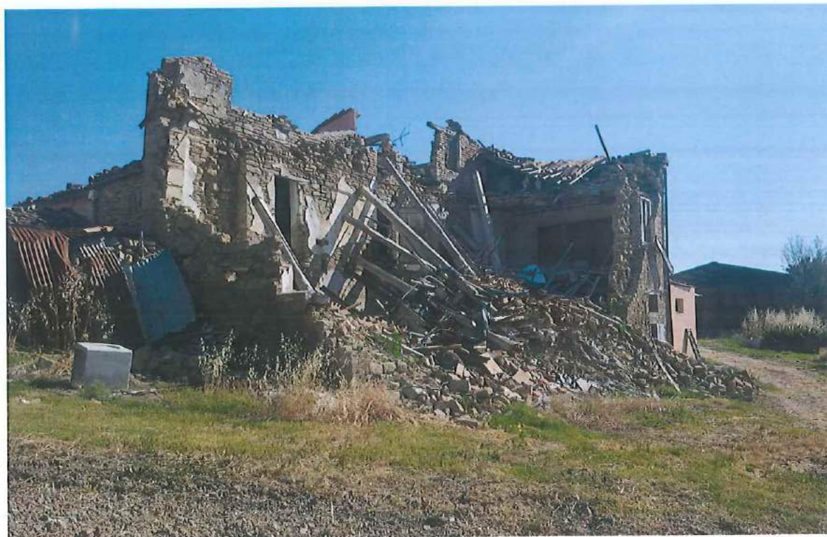
Fabbricato A, realizzato in mattoni e pietra con parziale crollo
