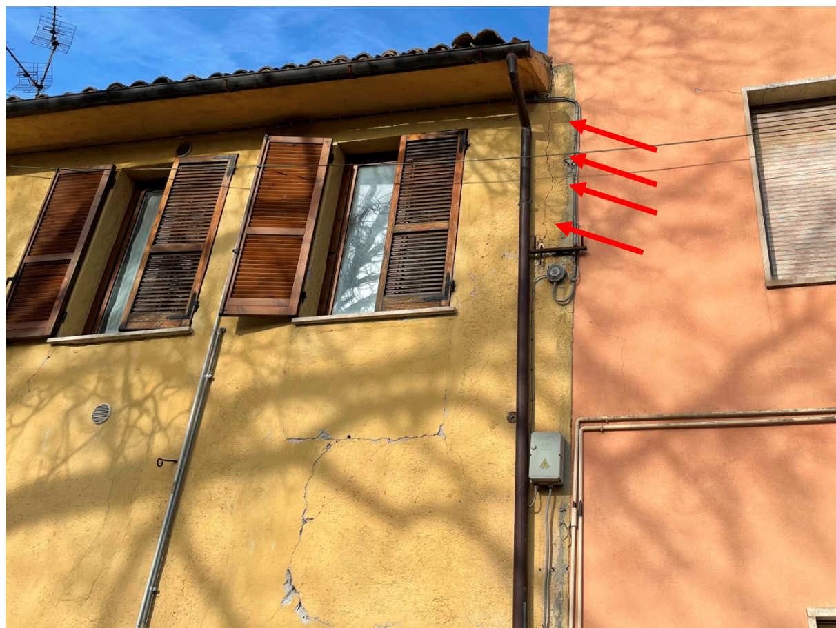
Foto 7 – 8 ( Distacco spigolo Sud – Est)
