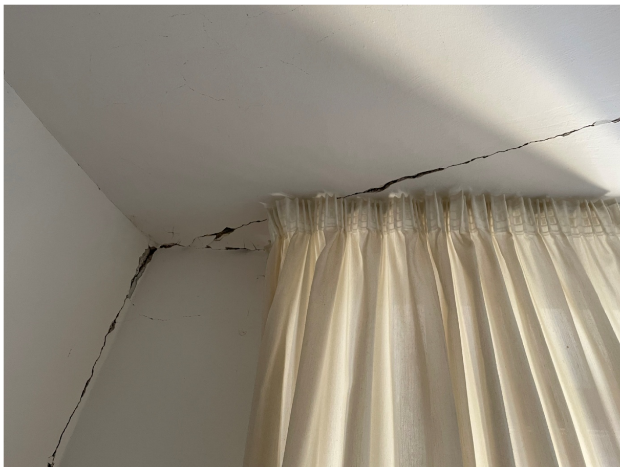
Foto 1 – 2 (Distacco spigolo Sud-Est)
