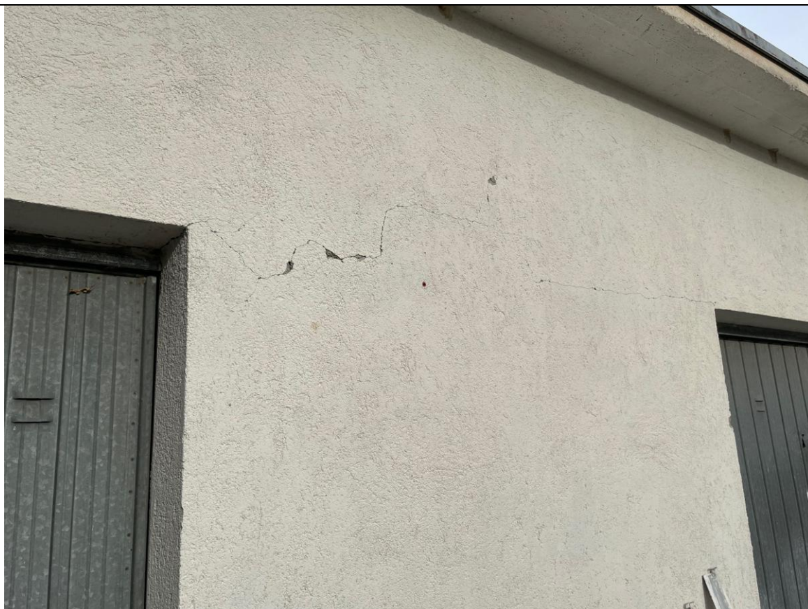
Foto 9 - Prospetto Sud – Dettaglio lesione
