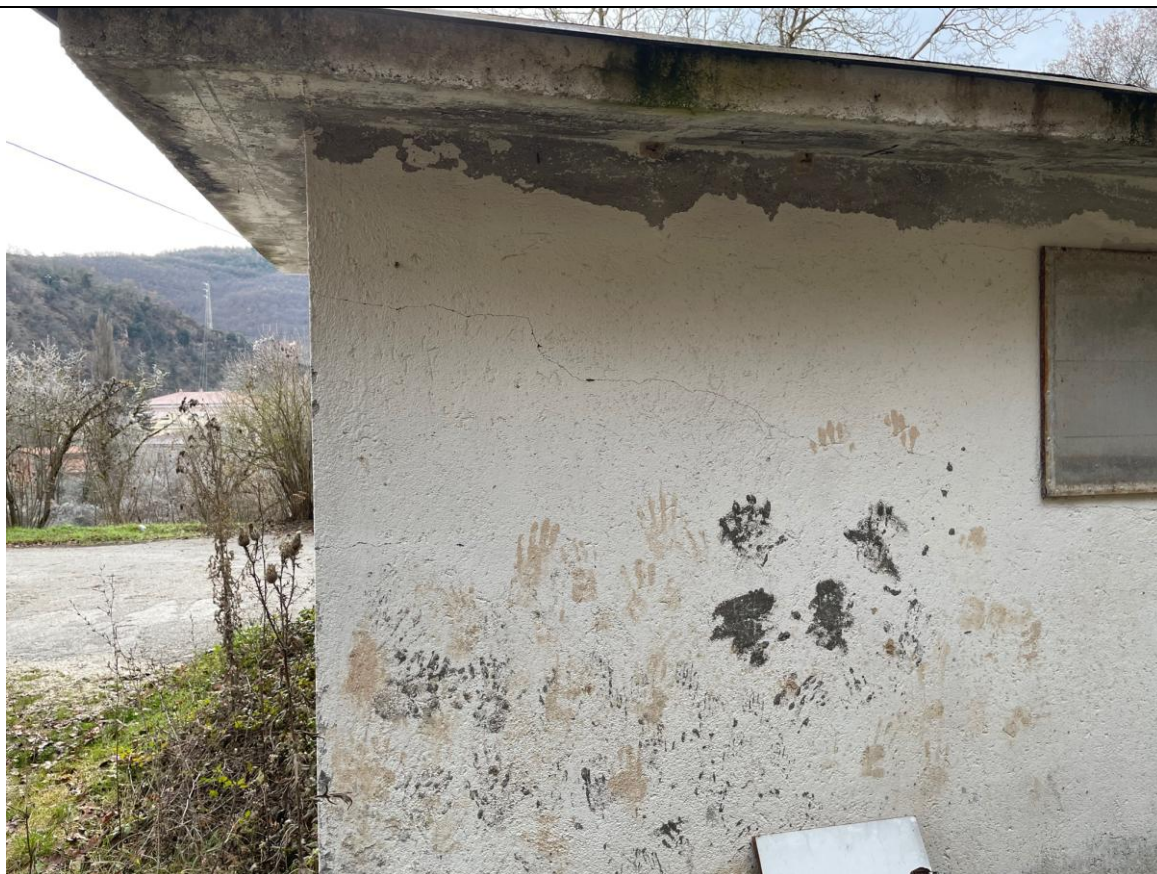
Foto 15 – Prospetto Nord – Dettaglio lesione
