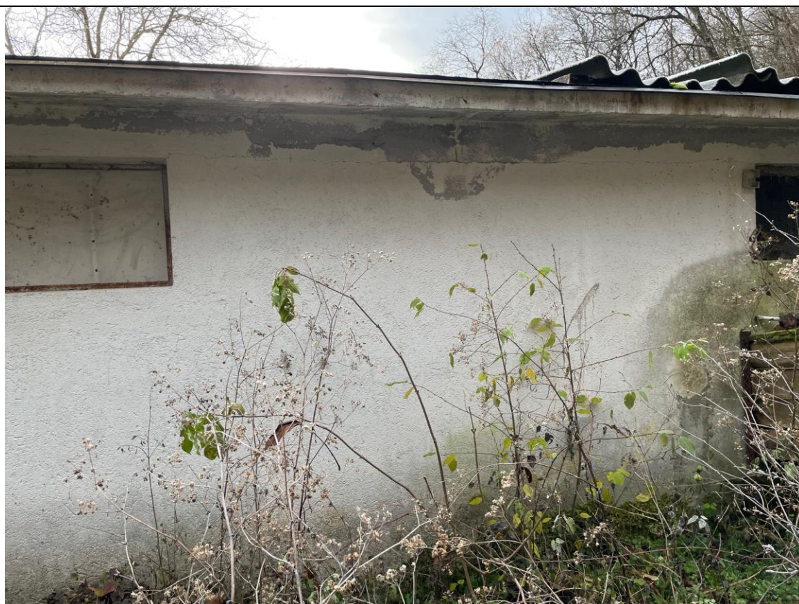
Foto 16 - Prospetto Nord – Dettaglio Lesione
