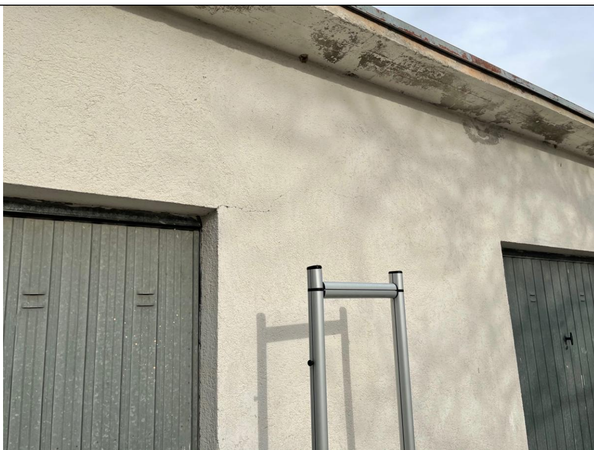
Foto 10 - Prospetto Sud – Dettaglio lesione
