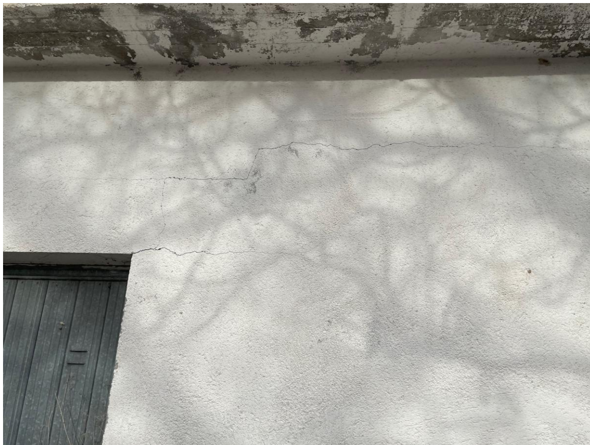
Foto 11 - Prospetto Sud – Dettaglio lesione
