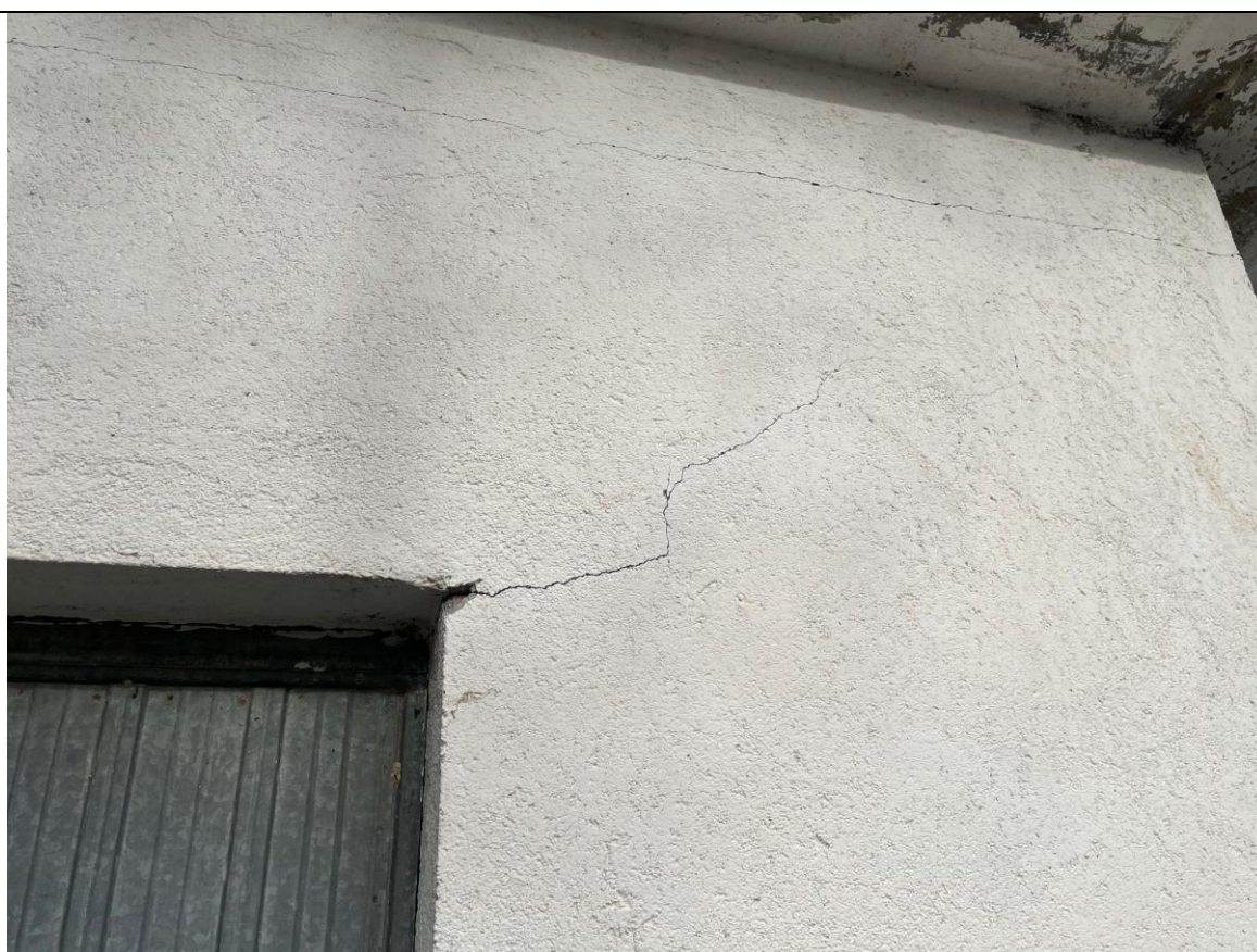
Foto 12 - Prospetto Sud – Dettaglio lesione
