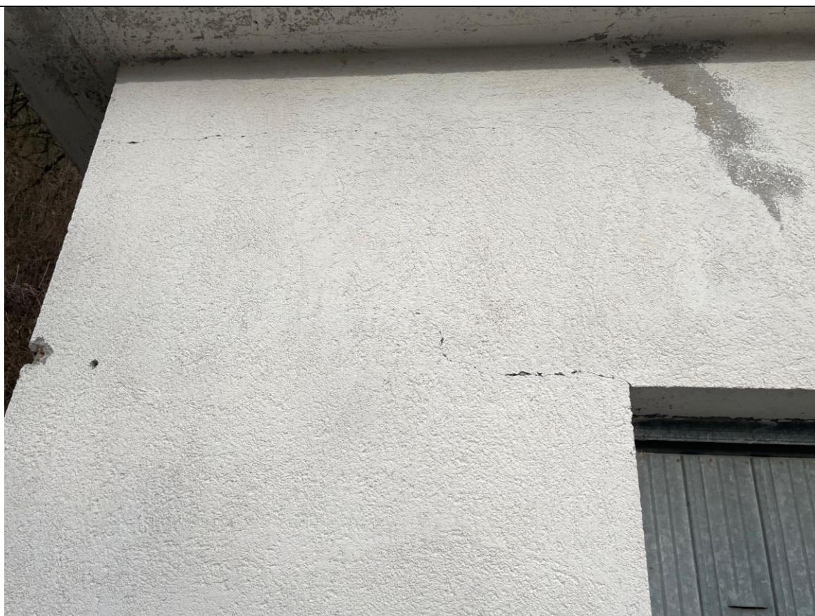
Foto 8 - Prospetto Sud – Dettaglio lesione
