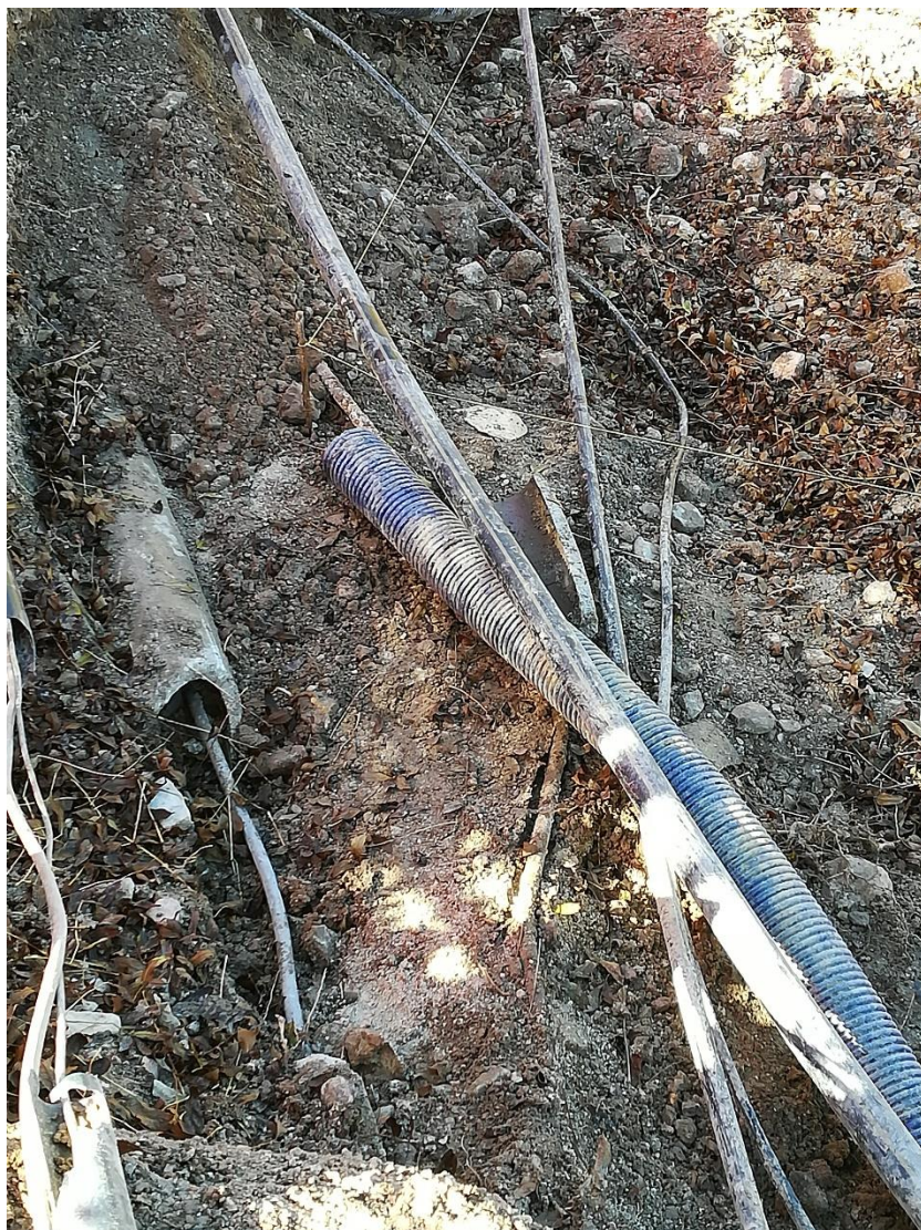
Foto 1 – Dettaglio dell'interferenza dei sottoservizi con sagoma delle fondazioni come da picchettamento eseguito dalla Ditta.
