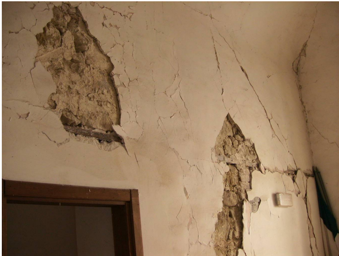
FOTO 11 EDIFICIO PRINCIPALE – PARETE INTERNA LESIONATA
