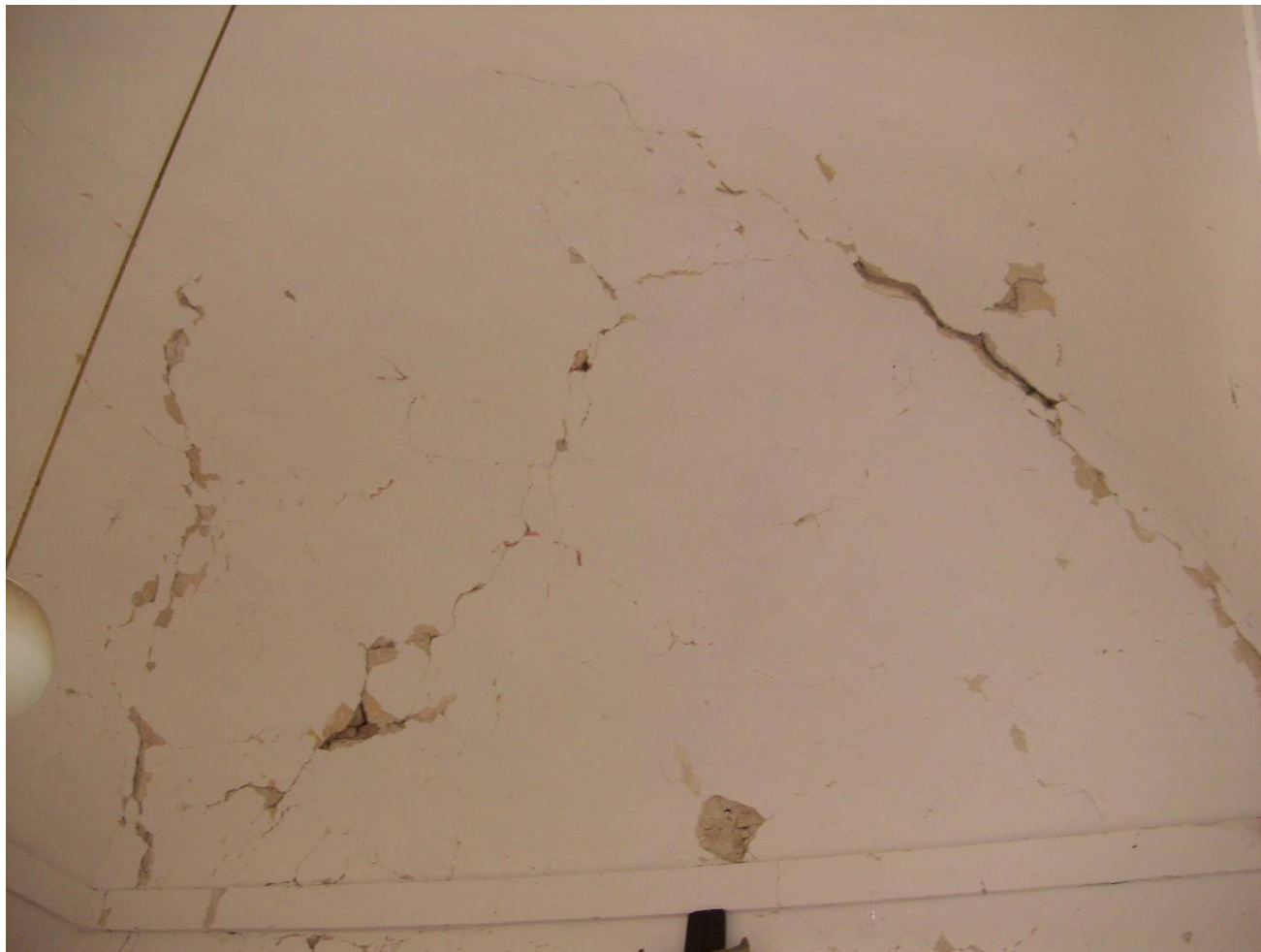
FOTO 9 EDIFICIO PRINCIPALE -LESIONI DIFFUSE AL CONTROSOFFITTO IN CAMORCANNÀ
