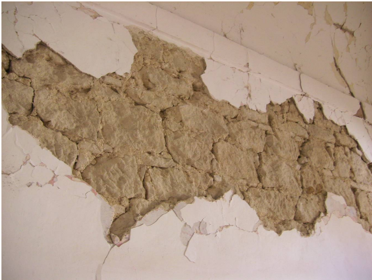
Foto 5 EDIFICIO PRINCIPALE - PARTICOLARE DI PORZIONE DELLA MURATURA INTERNA CON CADUTA DI INTONACO E MURATURA IN PIETRA LESIONATA
