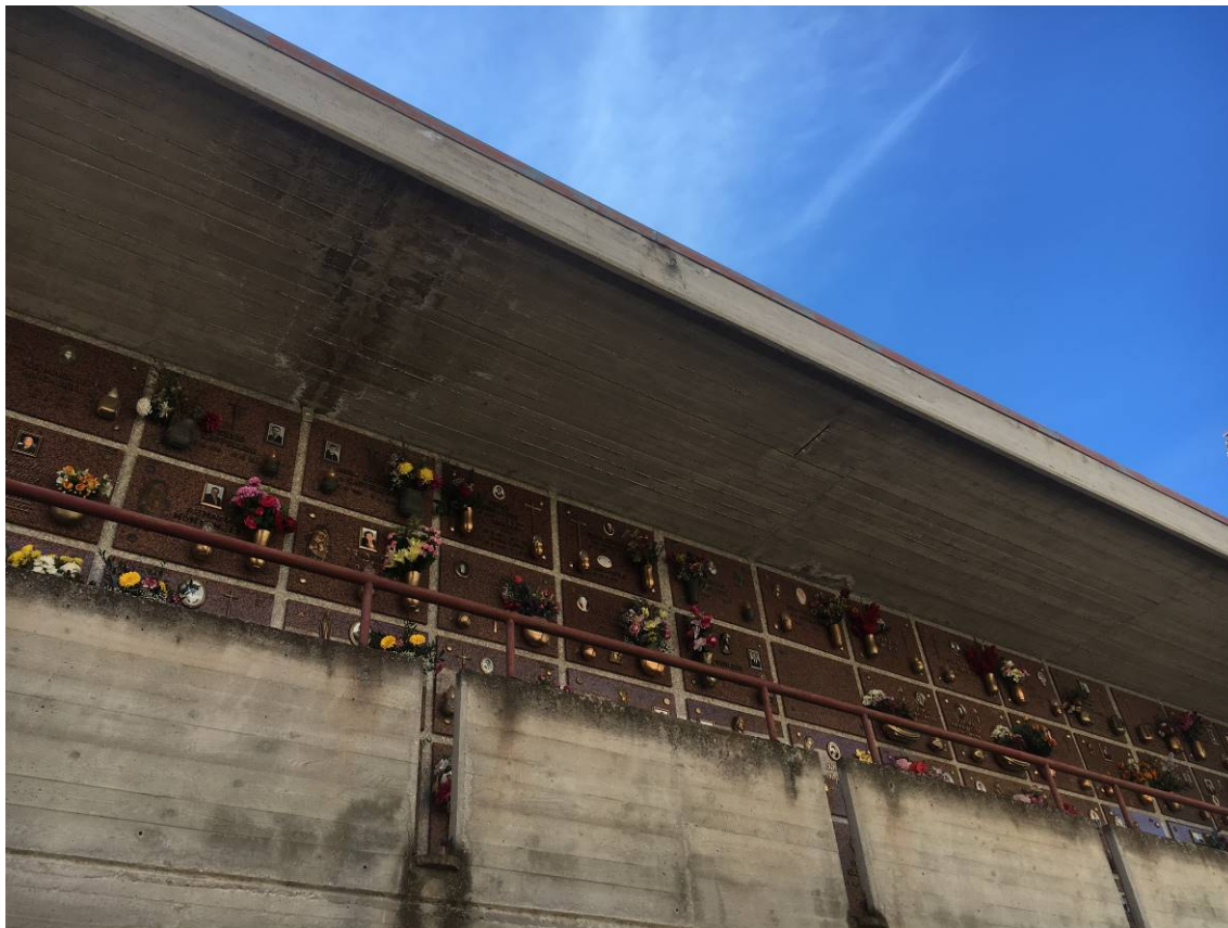
Foto 20 PADIGLIONE LOCULI (COSTRUZIONE 8)–INFILTRAZIONE DI ACQUA
