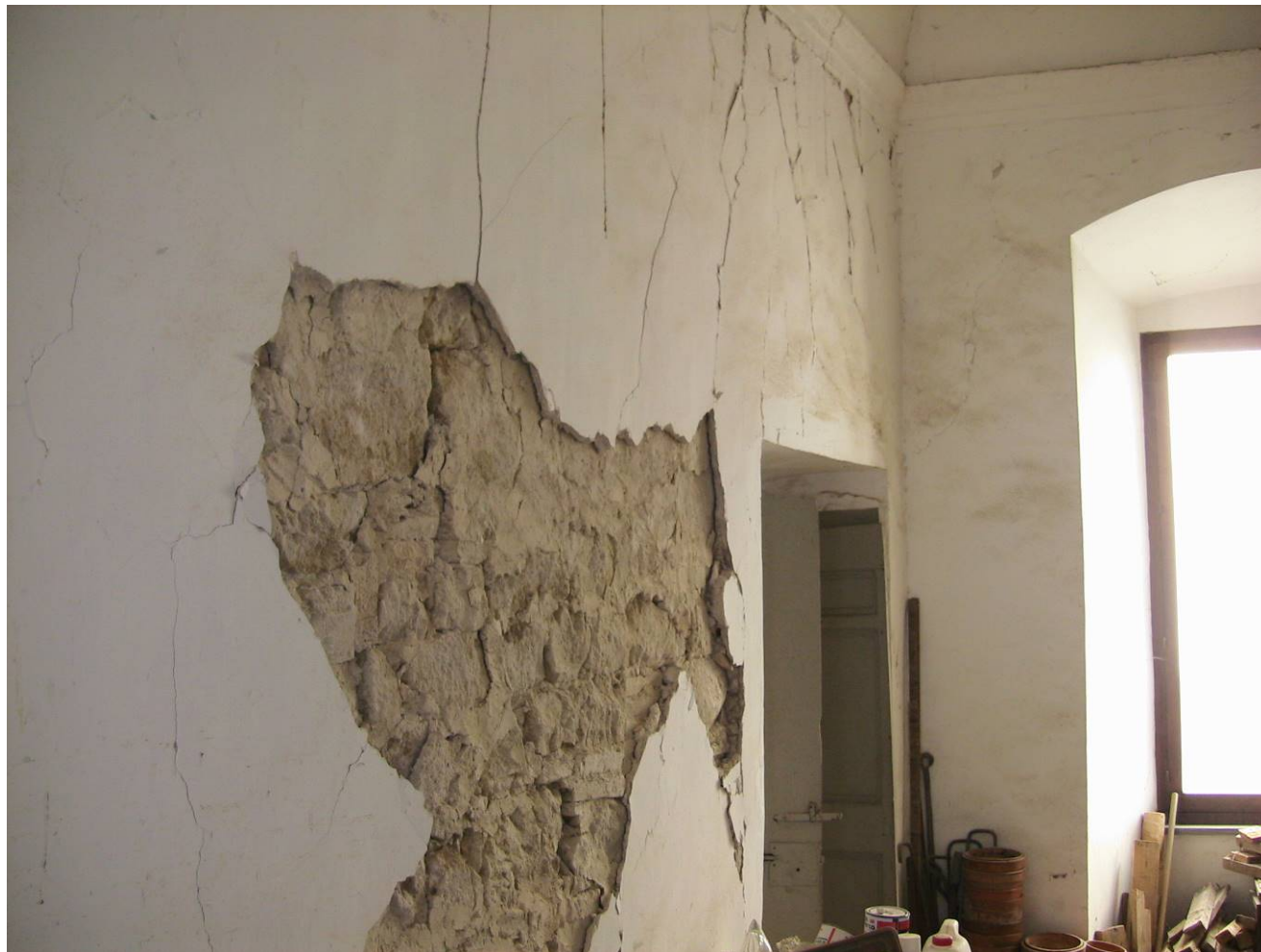
FOTO 6 EDIFICIO PRINCIPALE - ULTERIORE PARETE LESIONATA
