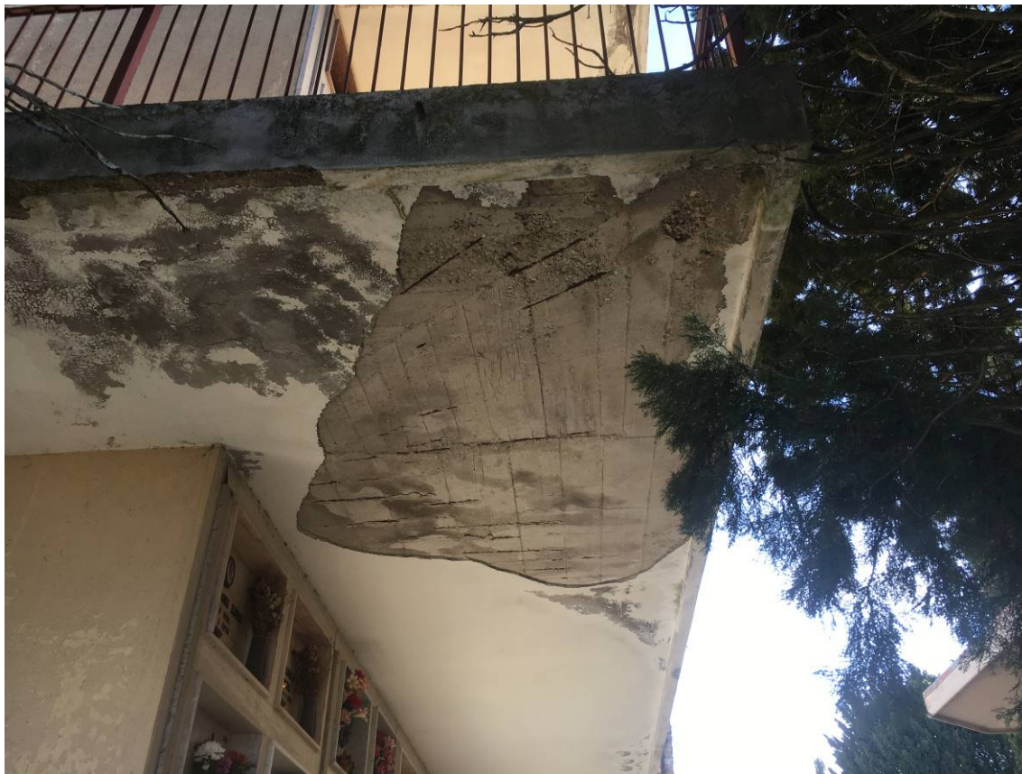
Foto 17 PADIGLIONE LOCULI (COSTRUZIONE 4) - STRUTTURE IN C.A. CON COPRIFERRO ESPULSO
