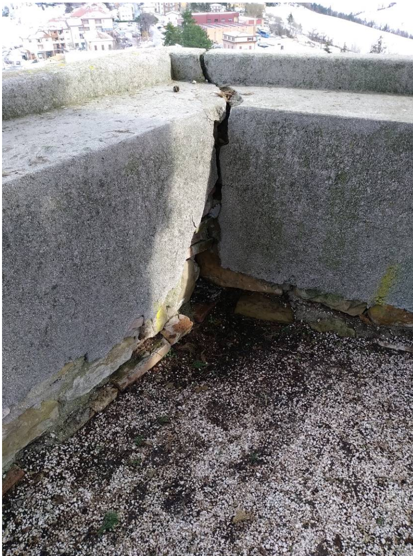
Foto 12 PARTICOLARE MURO DI RECINZIONE E CONTENIMENTO LESIONATO
