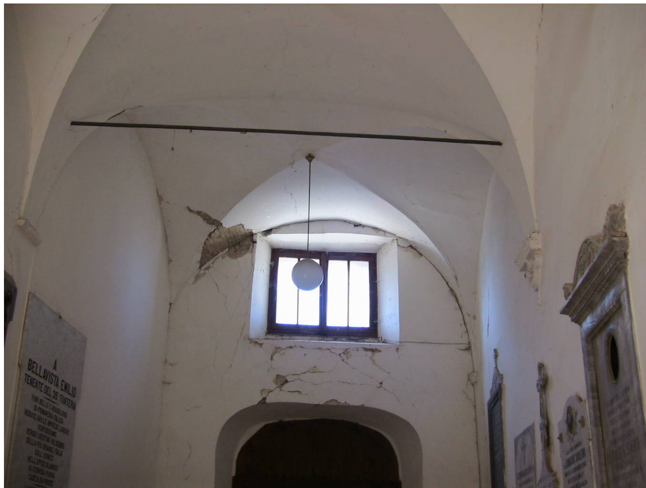
FOTO 10 EDIFICIO PRINCIPALE - LESIONI DIFFUSE LATO INGRESSO POSTERIORE DELL'EDIFICIO
