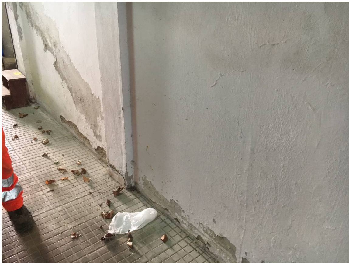
Foto 21 PADIGLIONE LOCULI (COSTRUZIONE 6)– LESIONI SULLE PARETE
