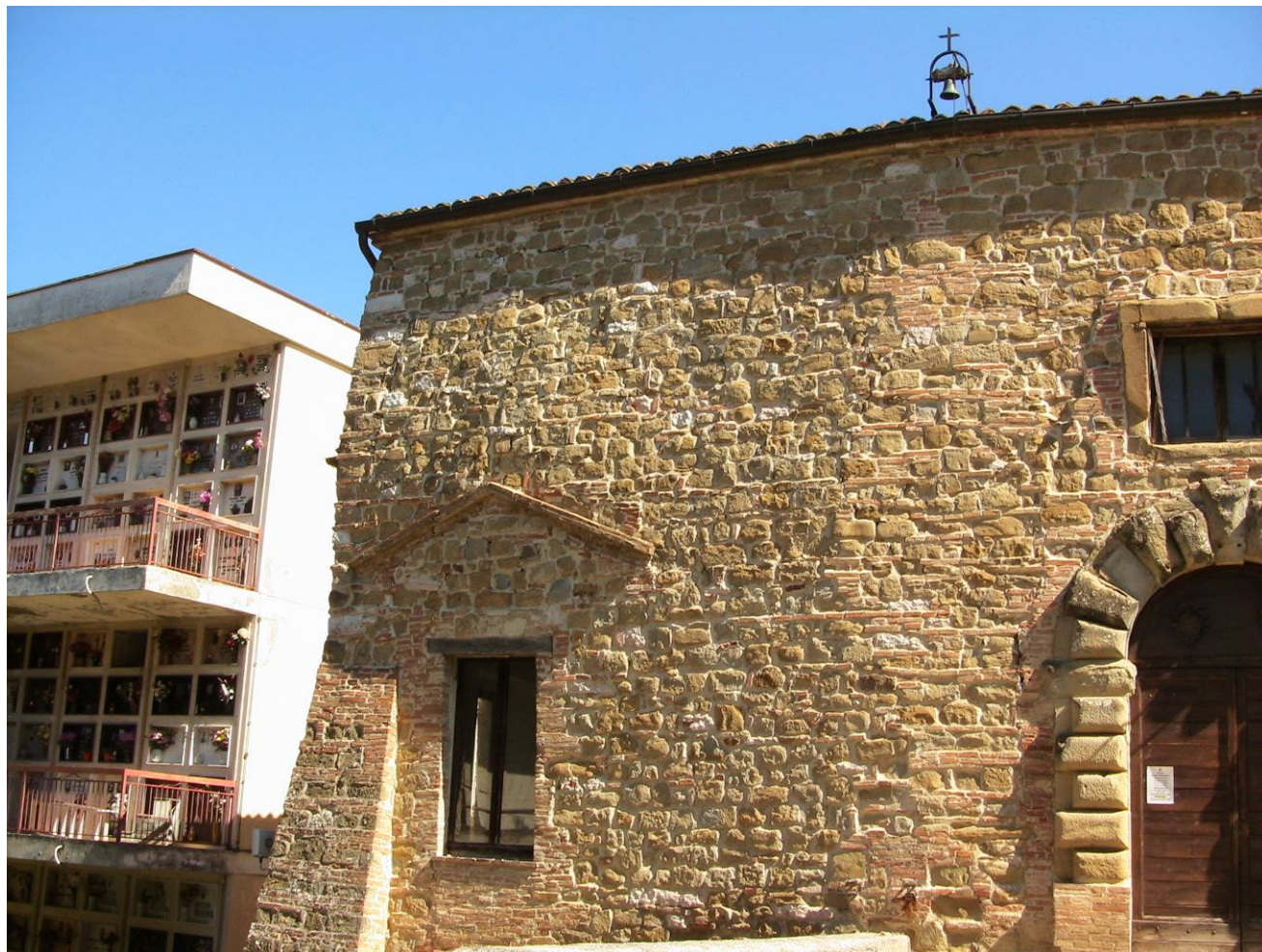
FOTO 1 EDIFICIO PRINCIPALE - FACCIATA ESTERNA LATO INGRESSO DELL'EDIFICIO DOVE SI NOTA LO SPANCIAMENTO NELLA PARTE SINISTRA
