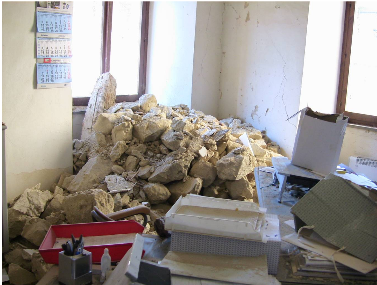
FOTO 4 EDIFICIO PRINCIPALE - PARTE INTERNA SEMPRE RIFERITO ALLO SPANCIAMENTO ESTERNO CON CROLLO DI PARTE DEL PARAMENTO MURARIO SOPRA LA SCRIVANIA
