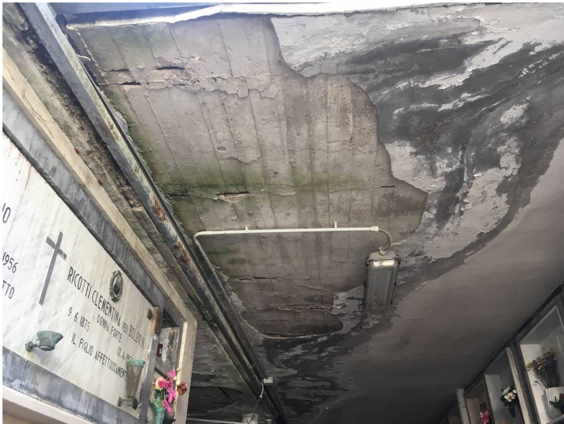
FOTO 18 PADIGLIONE LOCULI (COSTRUZIONE 6)–INFILTRAZIONE DI ACQUA
