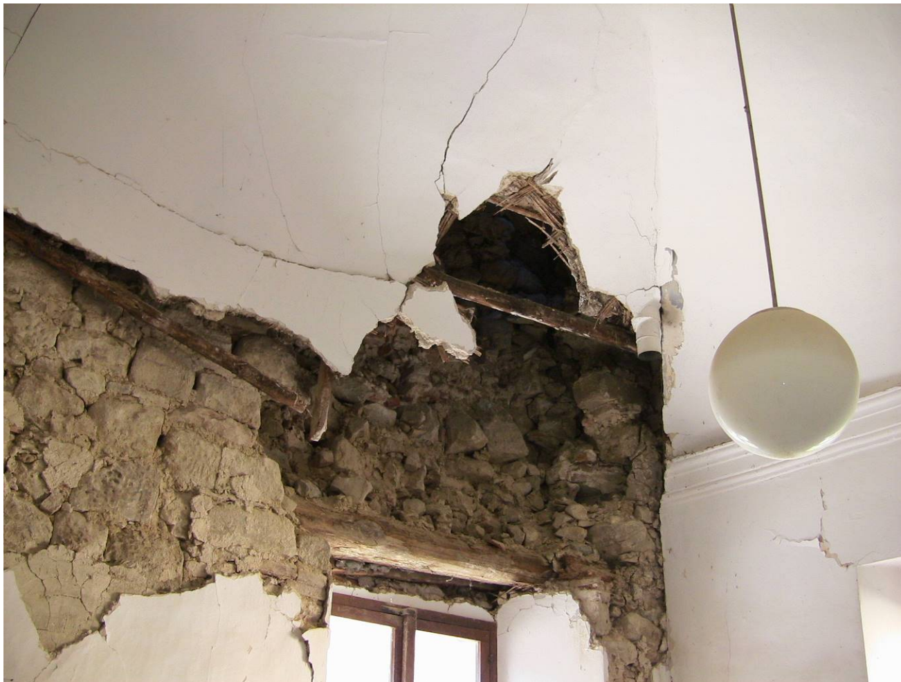
FOTO 3 EDIFICIO PRINCIPALE - PARTICOLARE DEL MURO NELLA PARTE INTERNA IN CORRISPONDENZA DELLO SPANCIAMENTO ESTERNO
