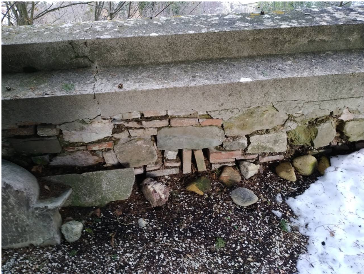
Foto 14 MURO DI RECINZIONE E DI CONTENIMENTO LESIONATO E CON PARTI MANCANTI
