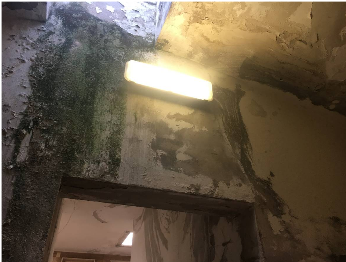
Foto 19 PADIGLIONE LOCULI (COSTRUZIONE 1)– INFILTRAZIONE DI ACQUA
