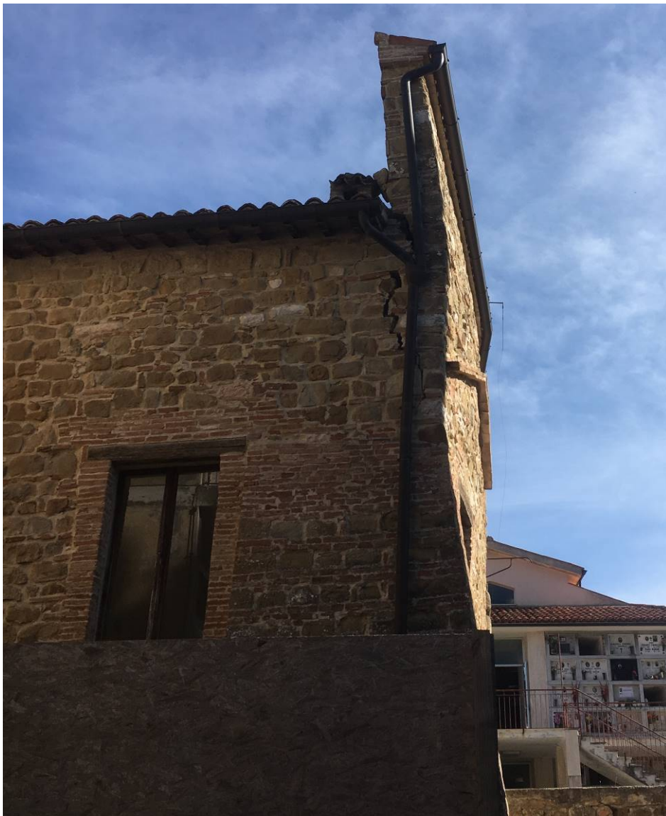
Foto 2 EDIFICIO PRINCIPALE – INCIPIENTE RIBALTAMENTO DELLA FACCIATA PRINCIPALE
