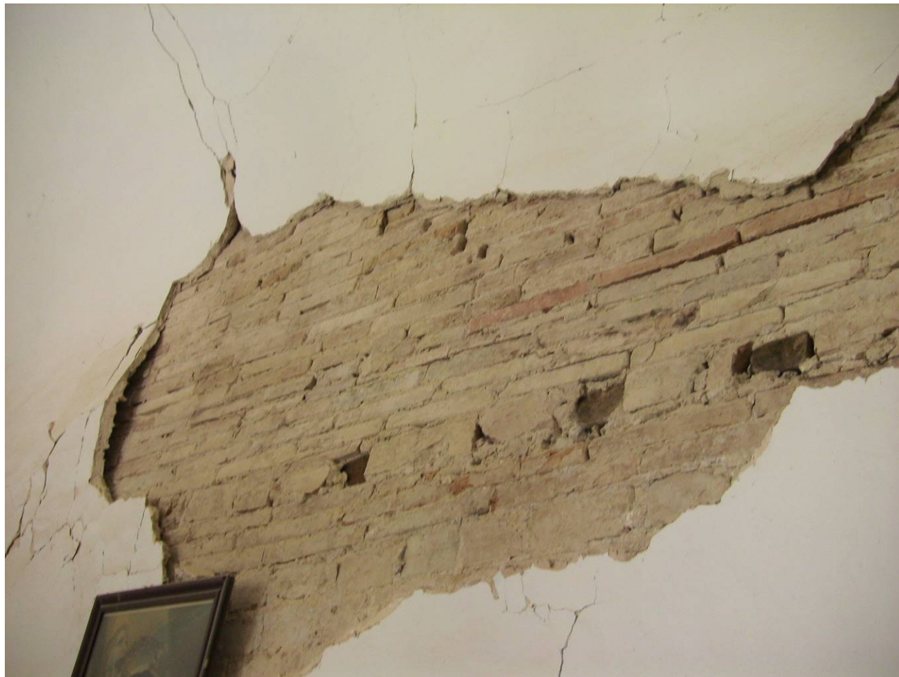
Foto 7 EDIFICIO PRINCIPALE - DISTACCO INTONACO CON LESIONI ALLA MURATURA IN MATTONI E PIETRA
