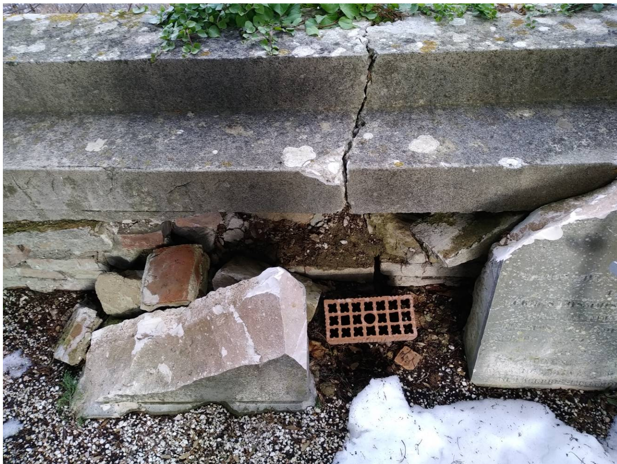
Foto 15 MURO DI RECINZIONE E DI CONTENIMENTO LESIONATO
