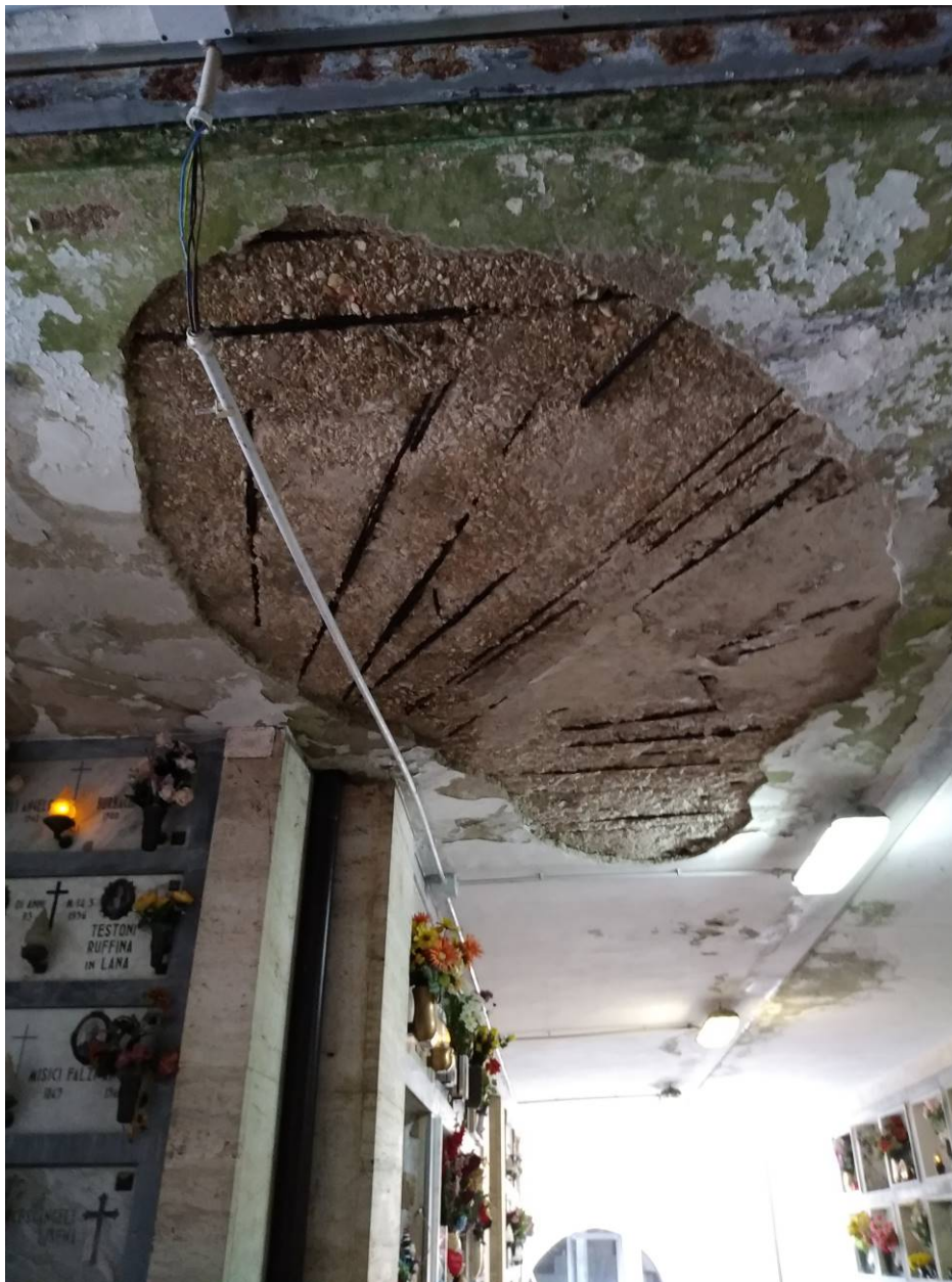
Foto 16 PADIGLIONE LOCULI (COSTRUZIONE 6) - STRUTTURE IN C.A. CON COPRIFERRO ESPULSO
