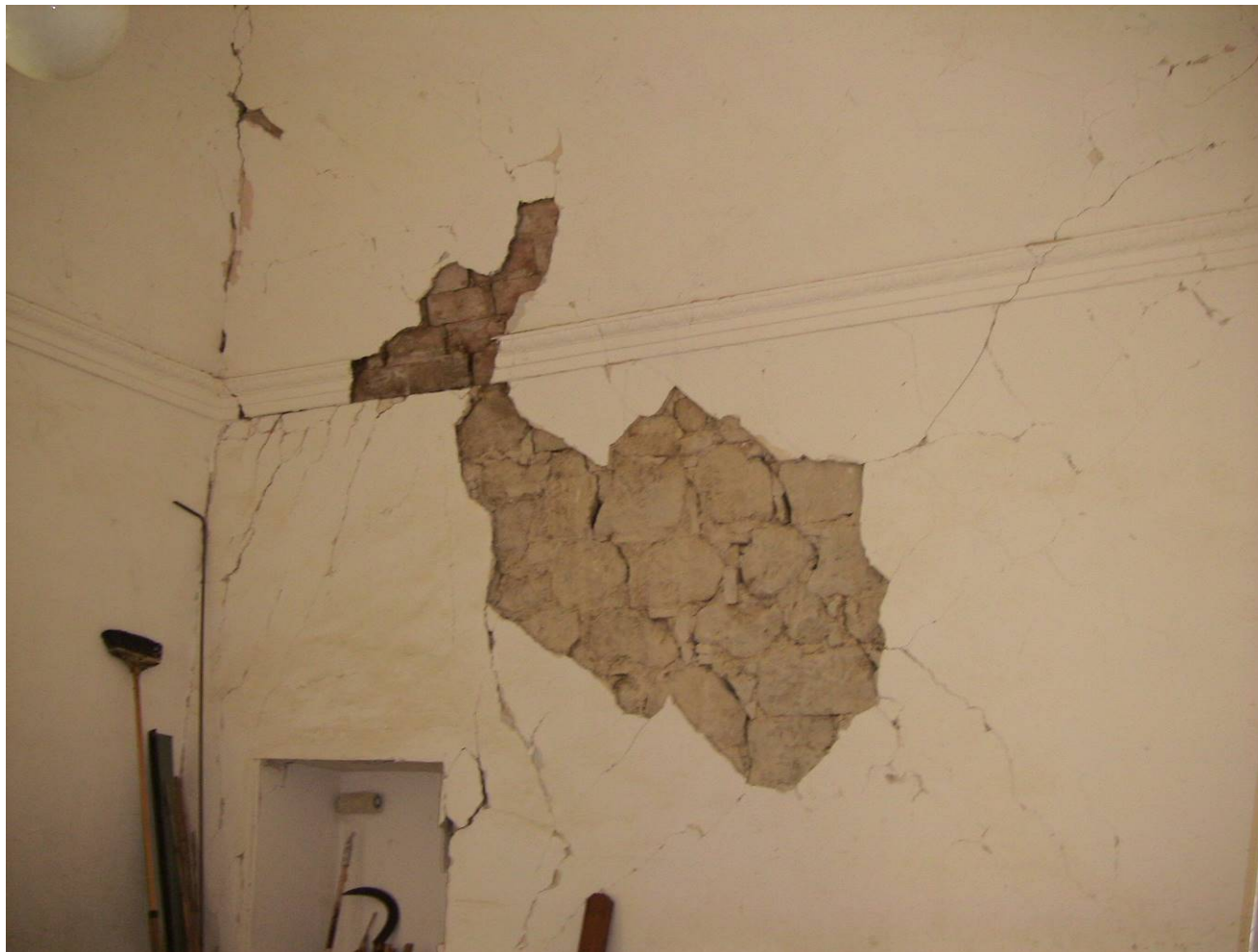
Foto 8 EDIFICIO PRINCIPALE - ALTRA PARETE INTERNA LESIONATA CON DISTACCO DI INTONACO
