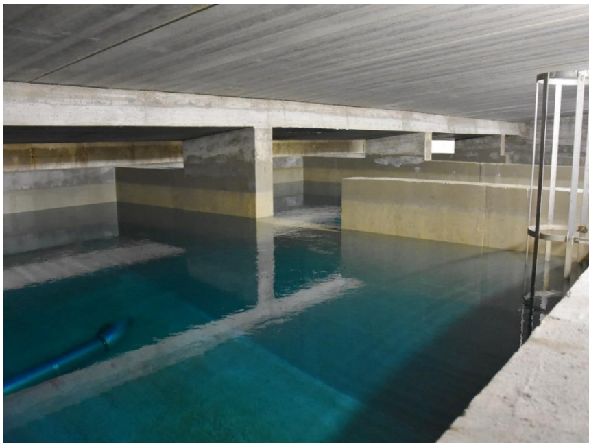
Vasca accumulo Campo Pozzi "Castel Trosino"
