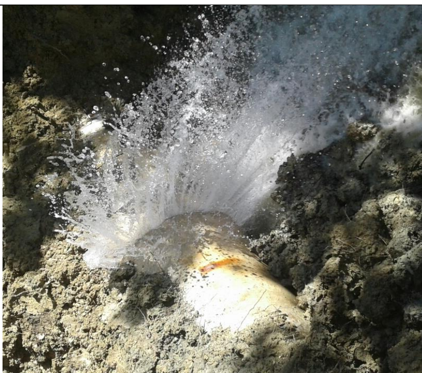
Sisma 2016: Rottura condotta Acquedotto Pescara
