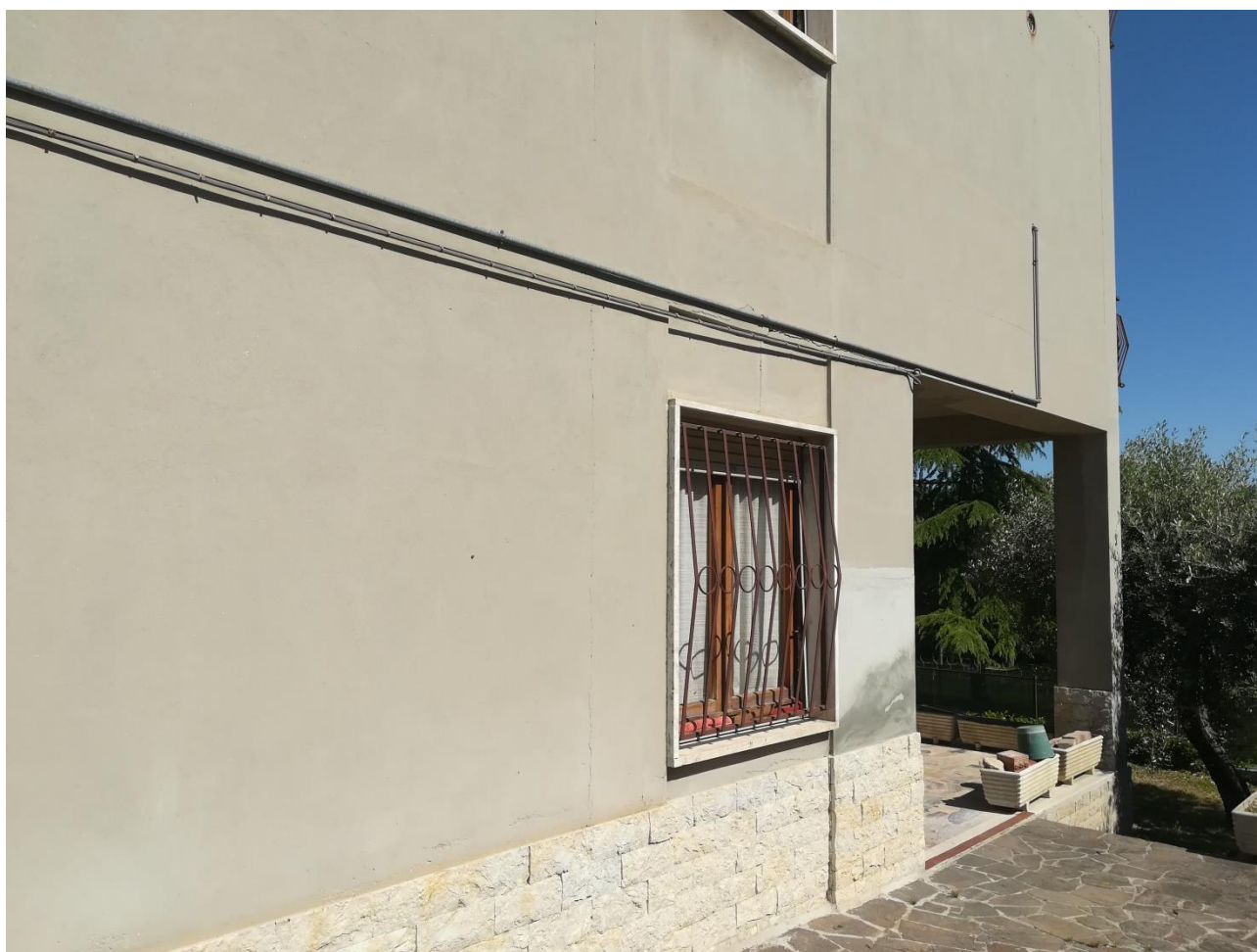
Foto 7: fronte Ovest, in evidenza l'omessa rappresentazione della finestra del piano terra
