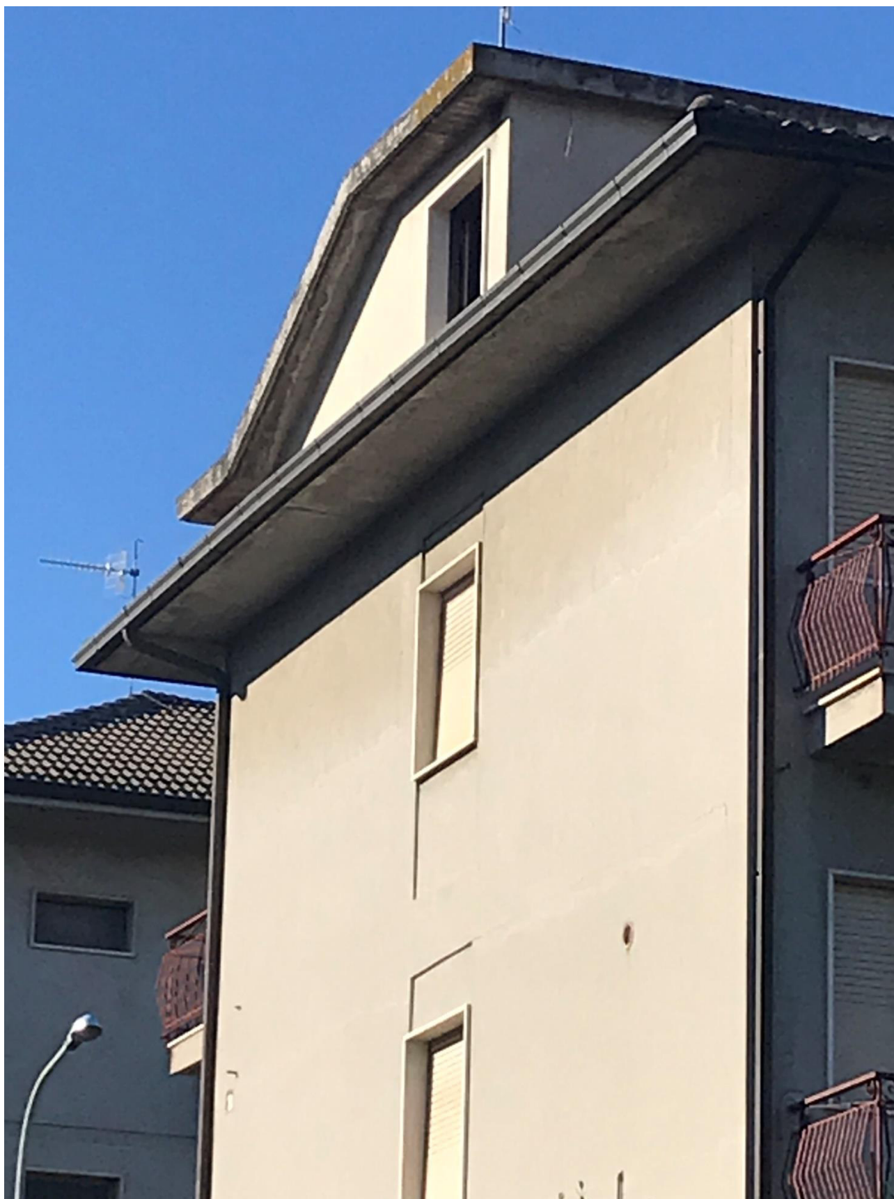
Foto 6: fronte Ovest, in evidenza l'omessa rappresentazione della finestra del piano terzo sottotetto
