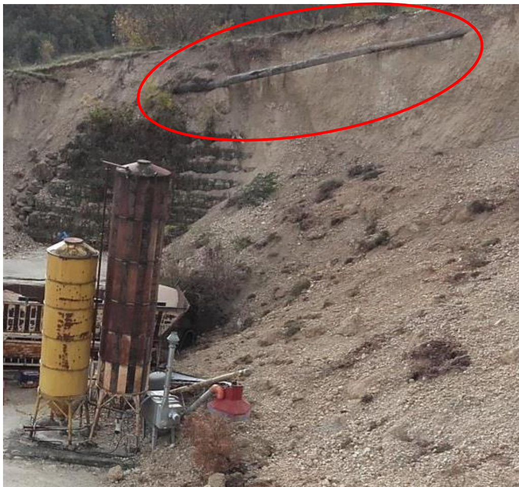
Figura 26 - Acquedotto del Pescara effetti del sisma 2016
