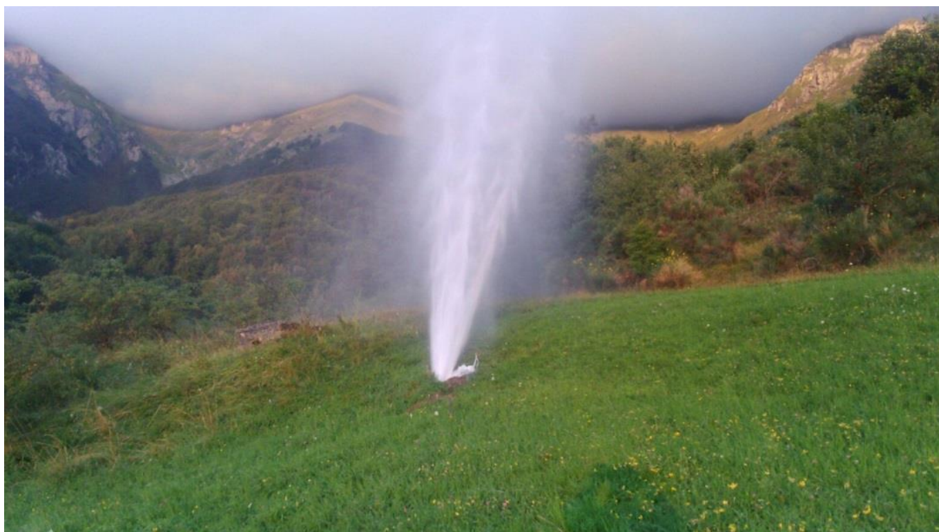
Figura 27 - Prima rottura adduttrice DN250 Zona Colle Casale Comune di Montegallo
