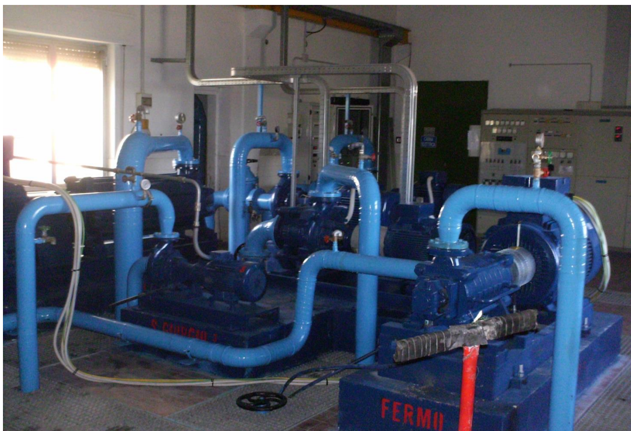
Figura 19 - Impianto di Soccorso Santa Caterin
