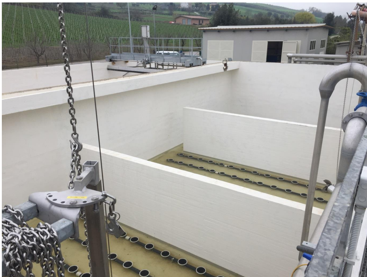
Figura 12 - Depuratore Santa Maria Goretti Offida
