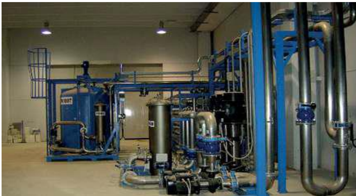
Figura 18 - Impianto di potabilizzazione Fosso dei Galli
