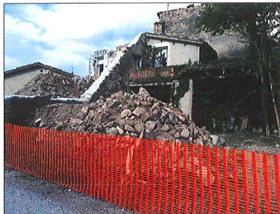
M.02 MACERIE ACCANTONATE IN PROSSIMITA' DEL SEDIME DEL FABBRICATO DEMOLITO
