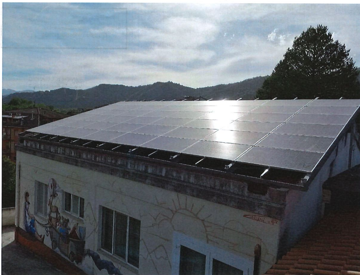
Foto n.2 - Vista nuovi moduli fotovoltaici su copertura mensa scolastica
