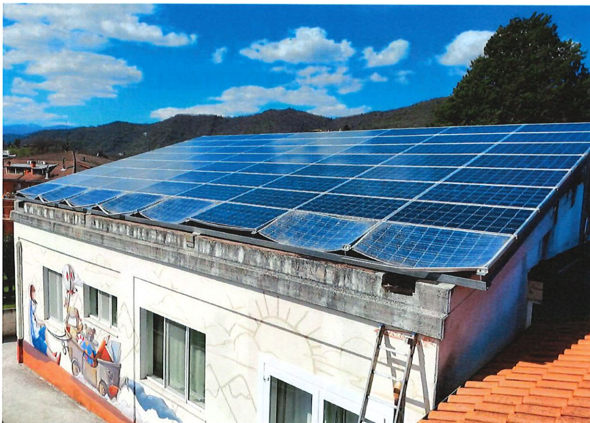
Foto n.1 – Vista vecchi moduli fotovoltaici guasti su copertura mensa scolastica
