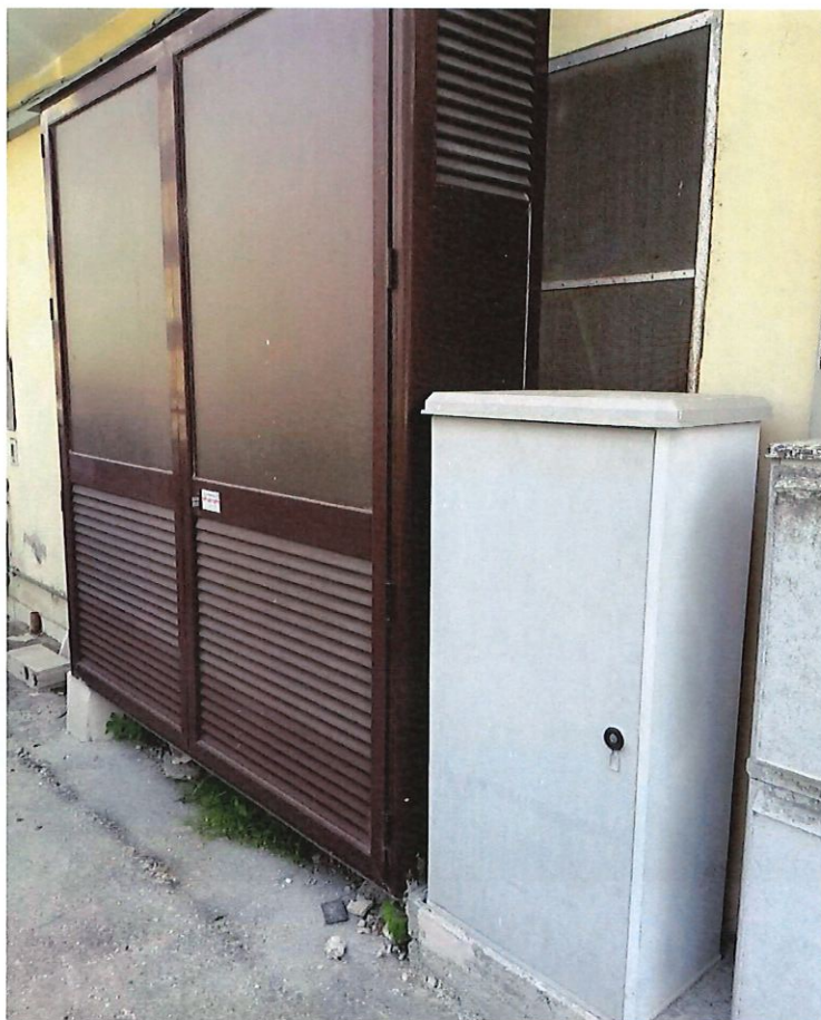
Foto n.8 – Vista alloggiamento quadri elettrici, inverter e contatori ente distributore (post-intervento)
