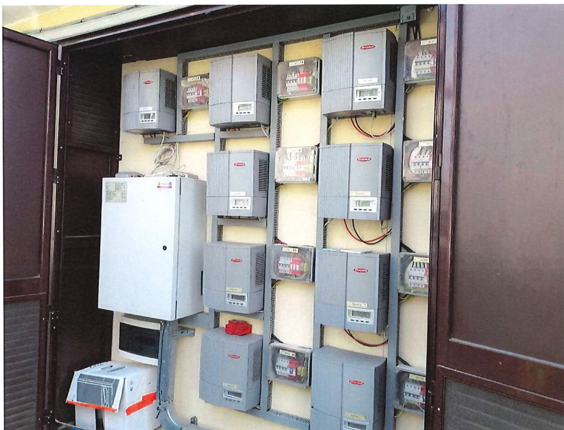
Foto n.10 – Vista alloggiamento quadri elettrici e inverter (post-intervento)
