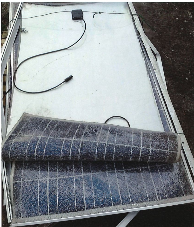
Foto n.3 - Vista dettaglio moduli fotovoltaici guasti
