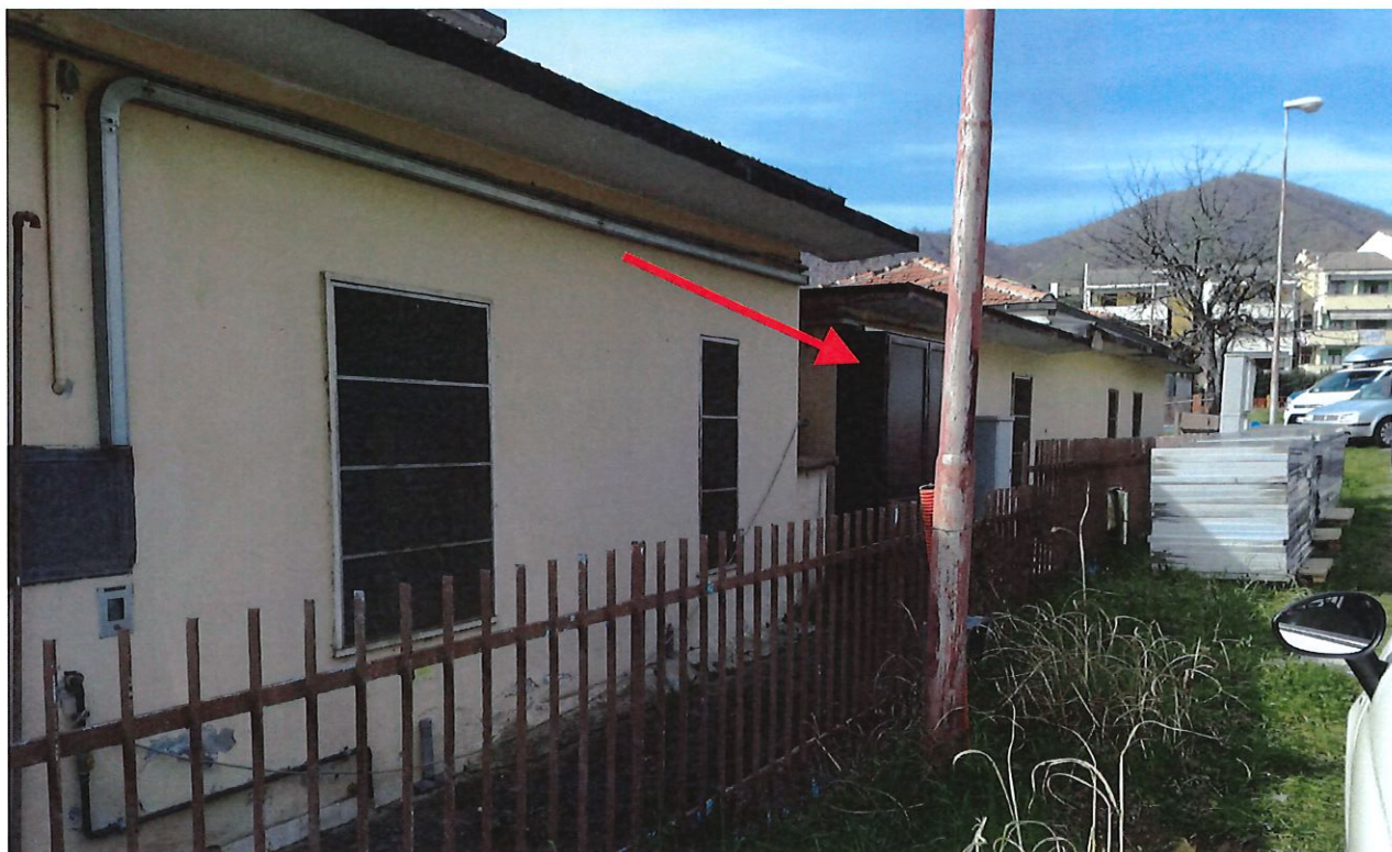
Foto n.6 – Vista alloggiamento quadri elettrici e inverter (pre-intervento)
