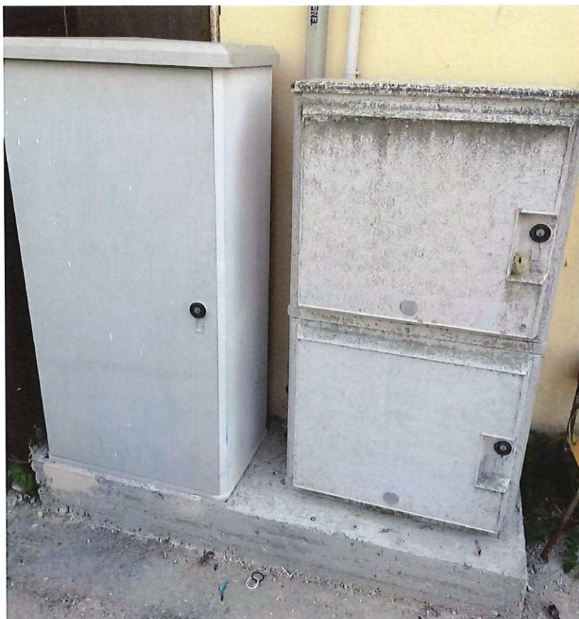
Foto n.9 – Vista alloggiamento contatori produzione e fornitura ente distributore (post-intervento)
