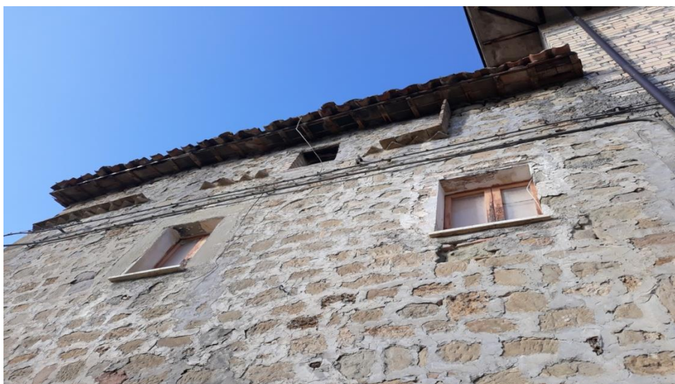
Foto 5 – Dettaglio della copertura con elementi a rischio crollo su pubblica via edificio Part.182-321
