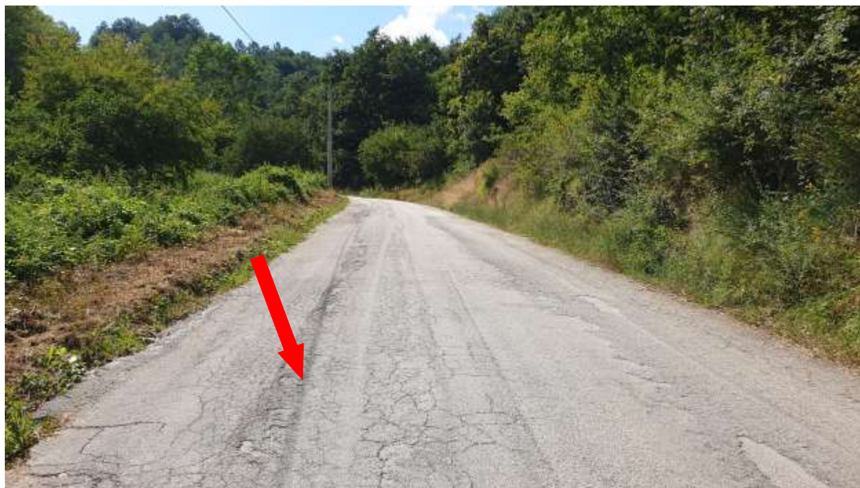
Danneggiamento della sede stradale.
