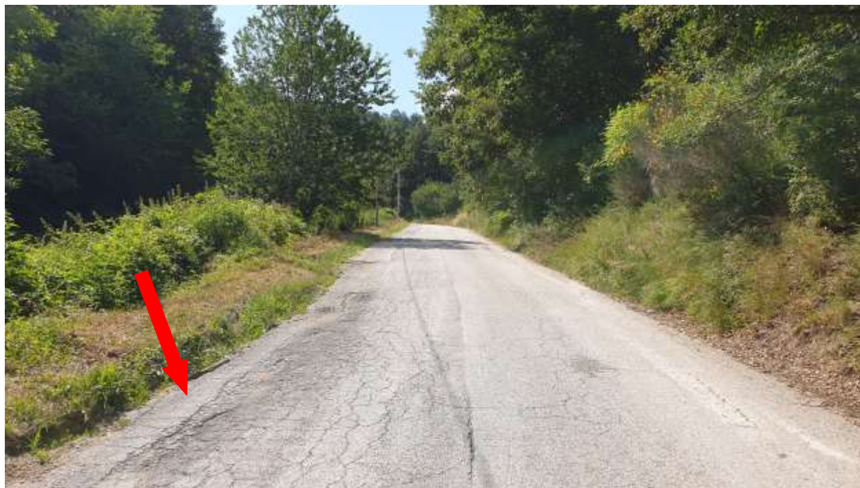
Danneggiamento della sede stradale.
