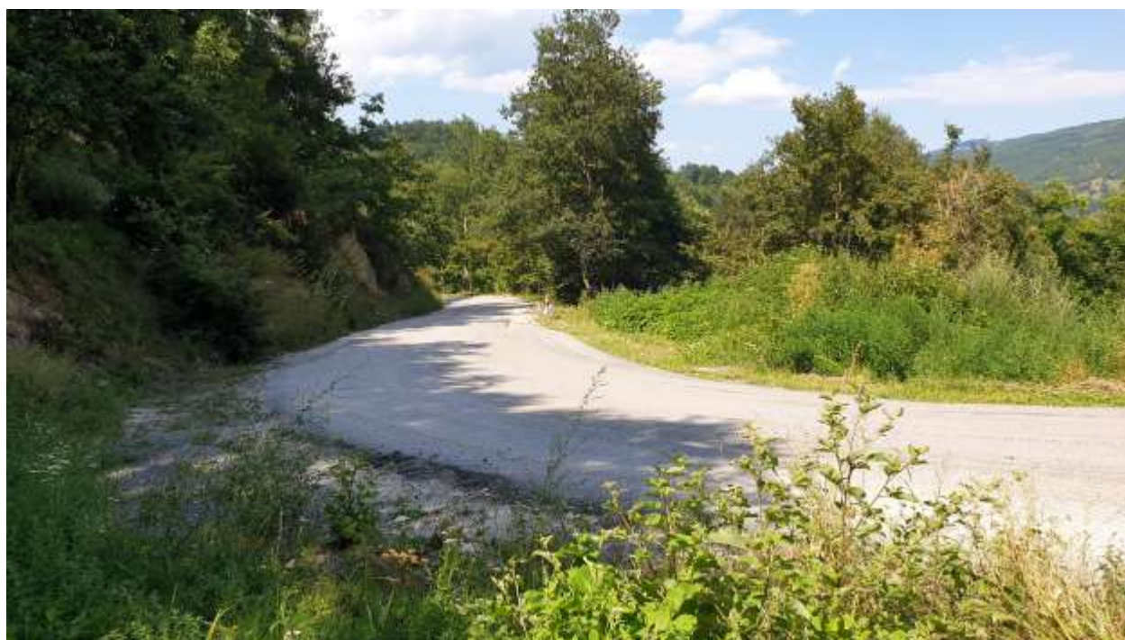
Tratto stradale oggetto del dissesto franoso.
