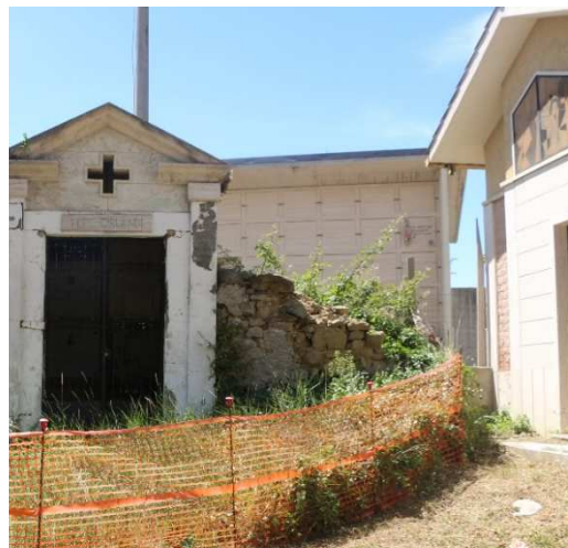
Figura 7 - Porzione di muro storico crollata adiacente alla US 11
