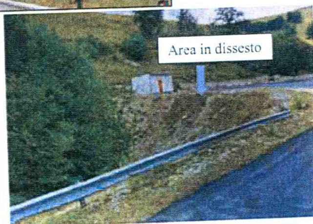
Particolari del tracciato e dell'area di dissesto alla data del luglio 2011
