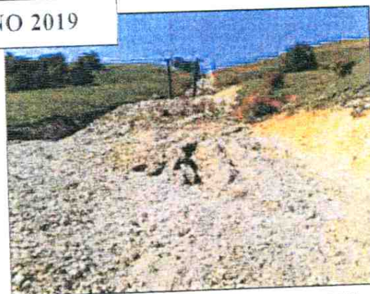
Danni causati dalle recenti precipitazioni piovose sul tracciato dell'impianto di risalita - data settembre 2019
