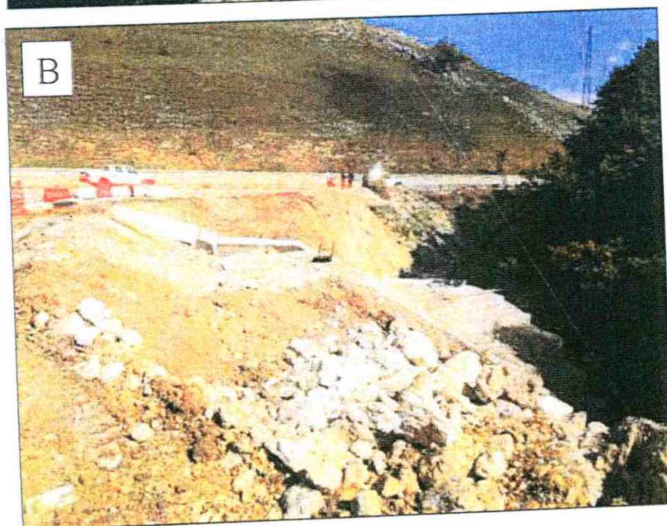
Attuale condizione del dissesto idrogeologico a valle del piazzale - data settembre 2019 (A - Ripresa dalla strada di accesso; B - Ripresa dal piazzale)
