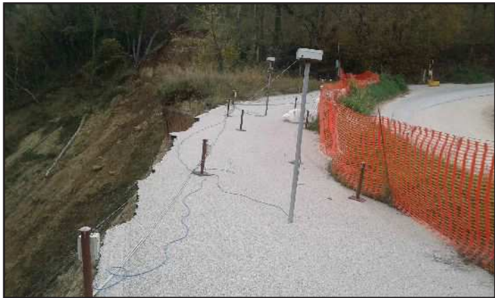
Foto n. 4 - Tratto di strada interessato dal dissesto visto da valle
