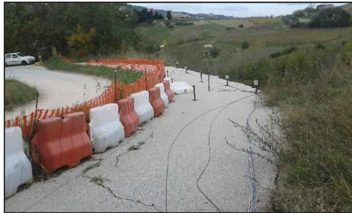
Foto n. 5- Tratto di strada interessato dal dissesto visto da monte
