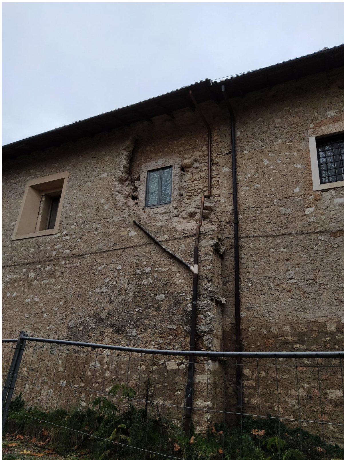
Immagine del crollo puntuale del "doppio" paramento"
