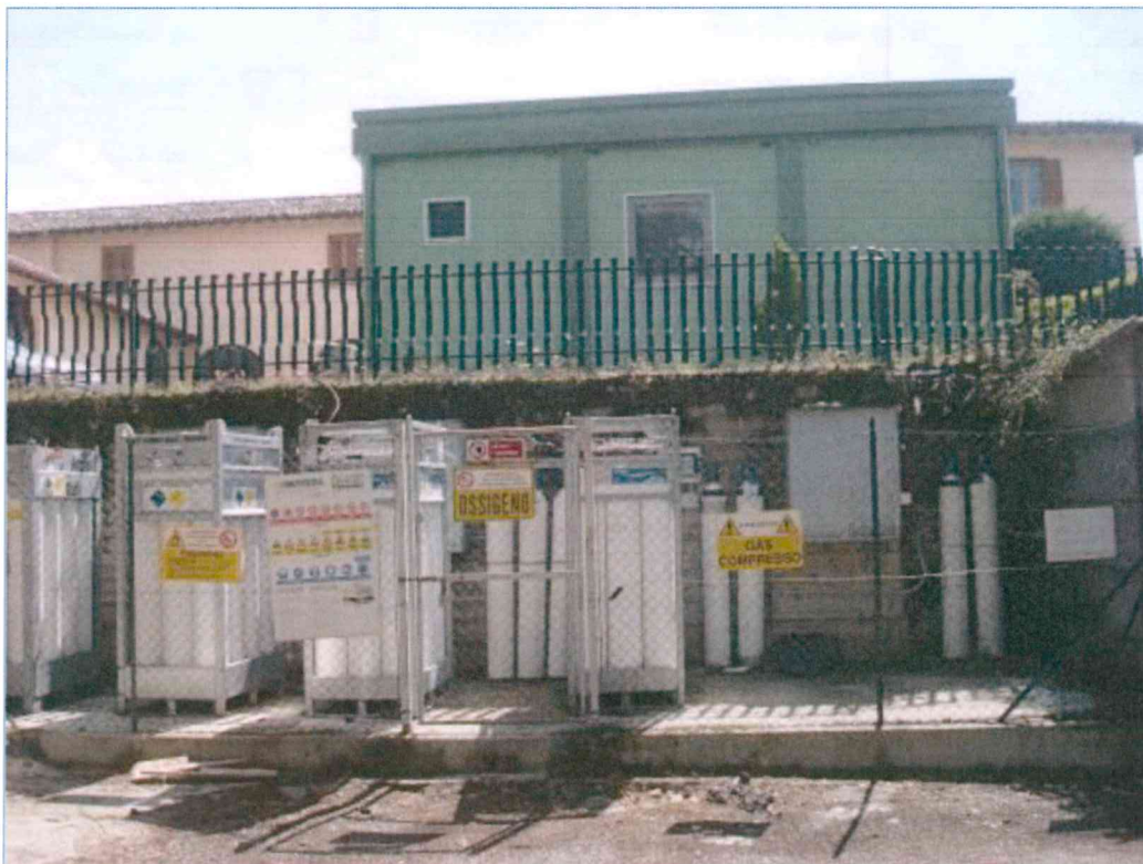
Deposito attuale bombole ossigeno (sotto zona 2a) con possibile interferenza su zona 1 sottostante.
